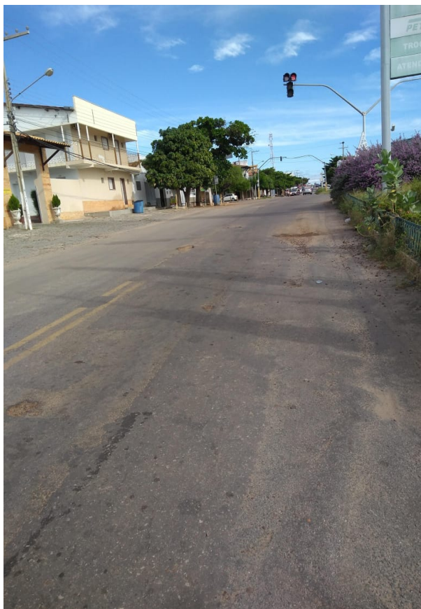
Figura 23: Desgaste do pavimento em trecho da Rua São João
