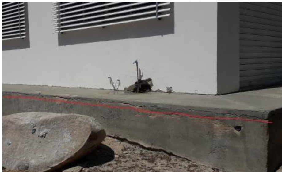
Figura 15- Recalque de fundação
