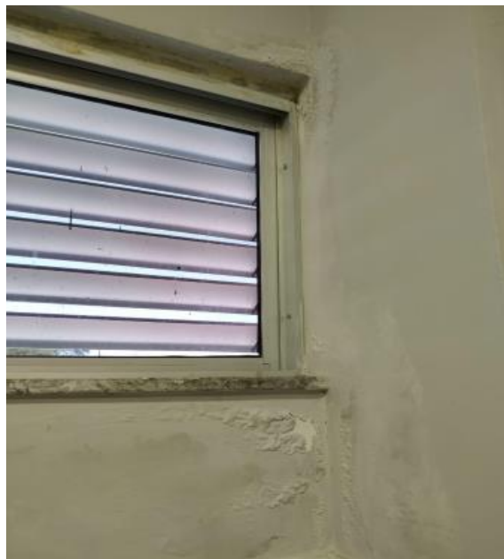
Figura 12- Infiltração próximo a esquadrias
