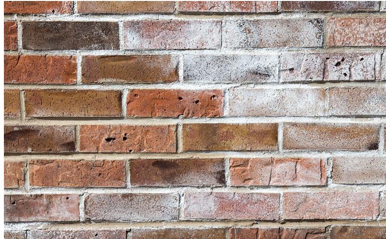
Figura 5- Eflorescência em fachada de tijolos
