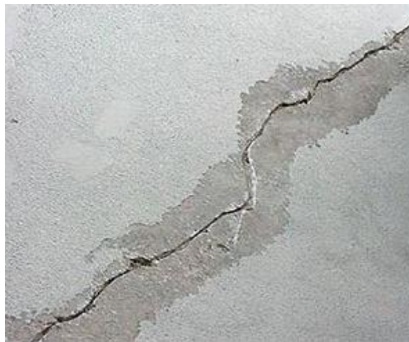
Figura 8- Fissura em alvenaria
