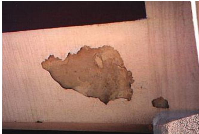
Figura 4- Deslocamento de placas
