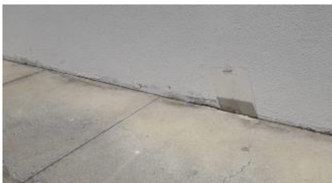
Figura 14- Fissuras no piso
