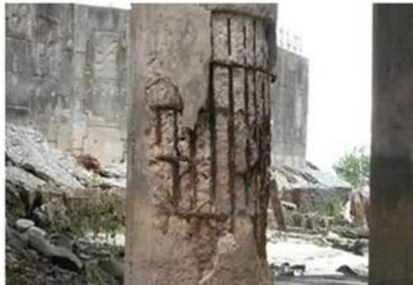
Figura 7- Pilar com armadura exposta devido ao estado de corrosão
