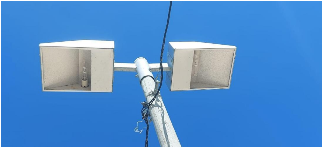
Figura 4 – Poste circular com luminárias de 2 pétalas com braços metálicos de 90°.
