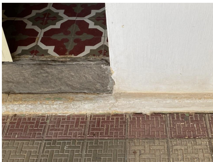
Figura 07: Desnível entre recepção e corredor.
