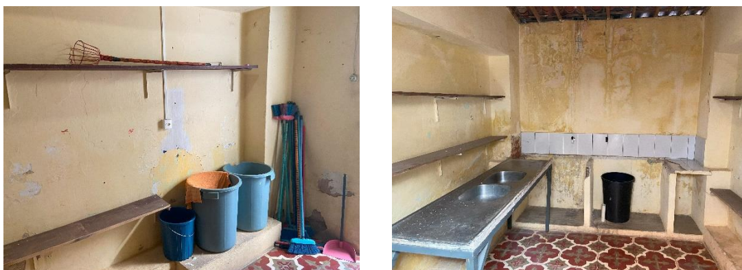
Figura 26 e Figura 27: Depósito dos materiais de limpeza.
