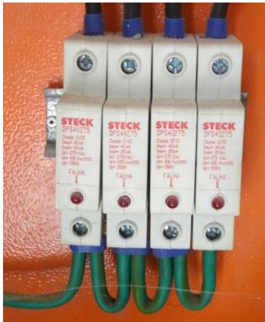
Figura 35- Dispositivo de Proteção contra Surtos
