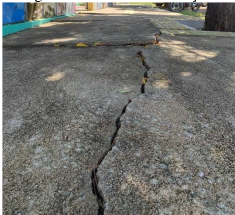
Figura 35: Ressaltos na calçada
