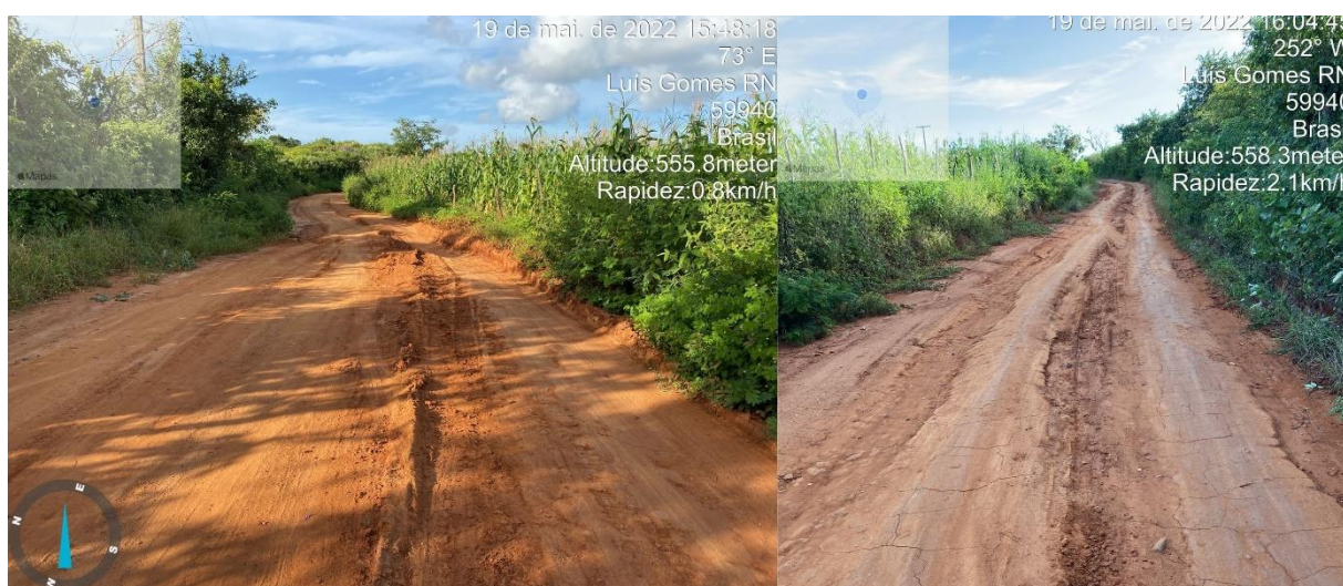
Figura 17: Trechos com trilha de roda nas estradas rurais de Luís Gomes-RN.
