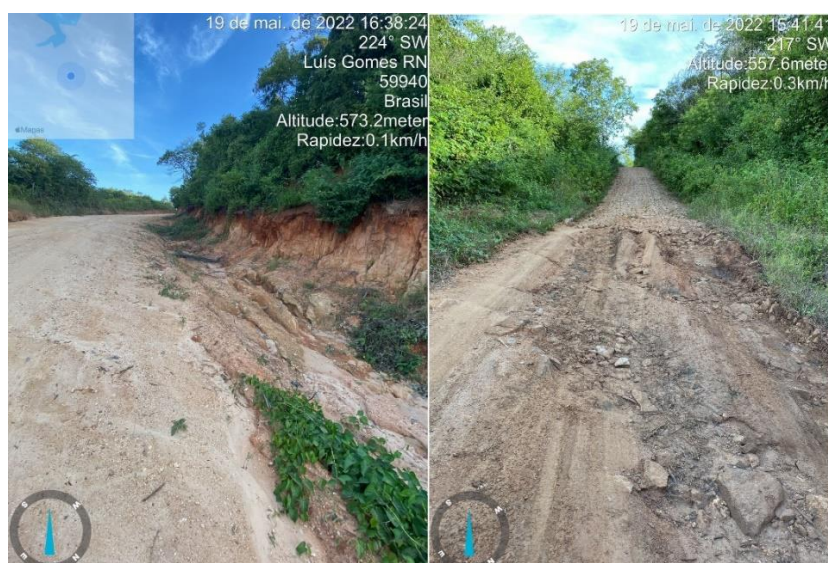
Figura 14: Trechos com a seção transversal inadequada das estradas rurais de Luís Gomes-RN.
