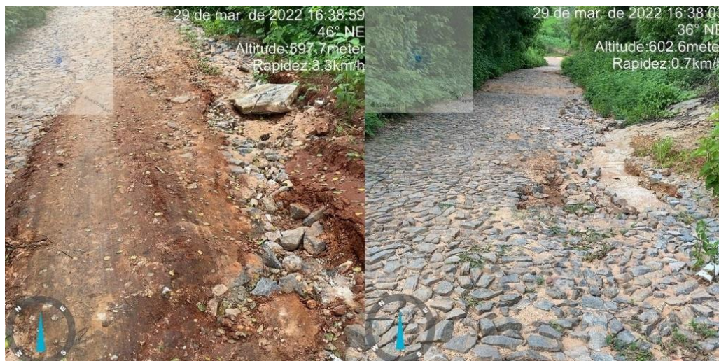
Figura 15: Trechos com defeitos característicos da falta de drenagem nas estradas rurais de Luís Gomes-RN.
