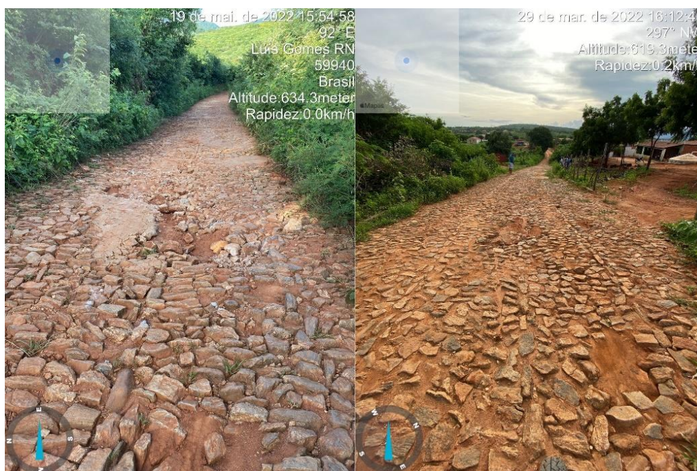
Figura 16: Trechos com buracos nas estradas rurais de Luís Gomes-RN.
