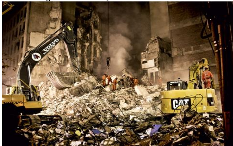
Figura 25 - Destroços do edifício Liberdade.
