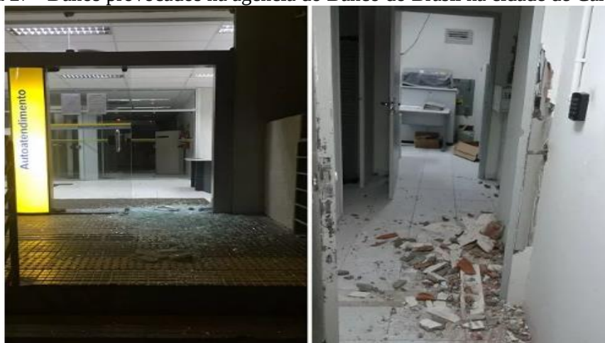
Figura 27 - Danos provocados na agencia do Banco do Brasil na cidade de Caraúbas – RN.
