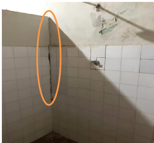
Figura 13 - Fissura no encontro das alvenarias.
