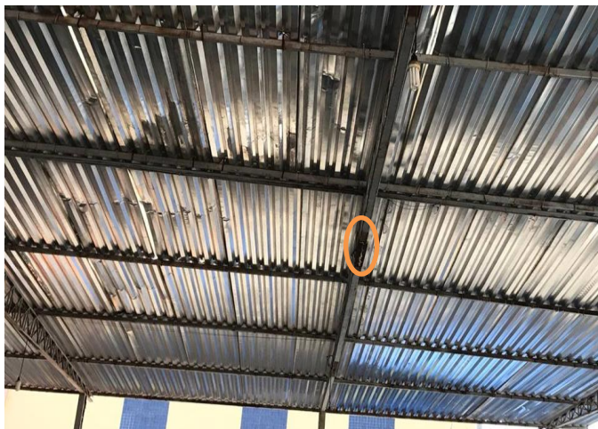
Figura 15 - Desgaste da cobertura de aço.
