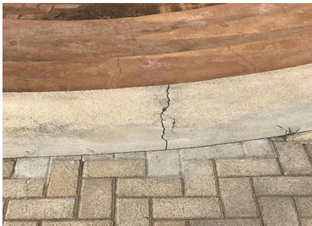
Figura 3 - Fissuras devido a retração plástica.
