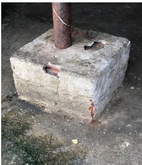
Figura 16 - Desgaste nos blocos de sustentação e no pilar de aço.
