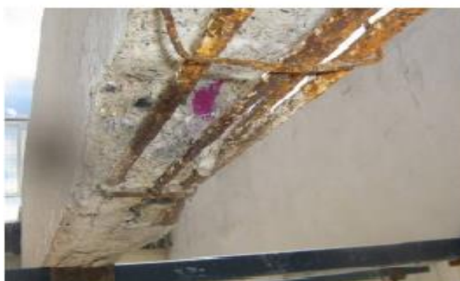
Figura 8 - Reação de Fenolftaleína em uma viga.
