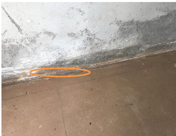
Figura 4 - Fissuras causadas devido ao recalque.
