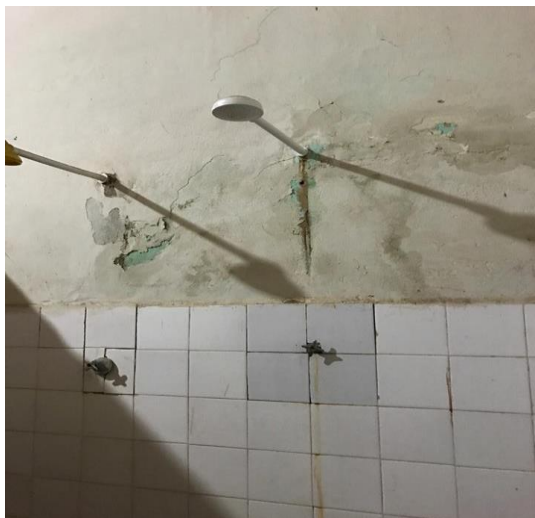
Figura 11 - Manifestações patológicas na alvenaria do banheiro.
