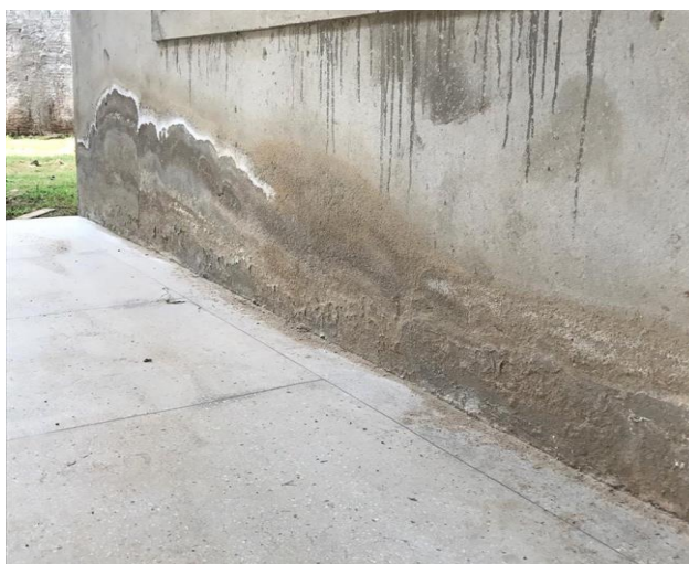
Figura 7 - Eflorescência em uma escola em construção.
