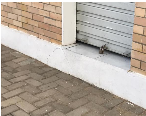
Figura 17 – Fissuras no Piso da edificação.
