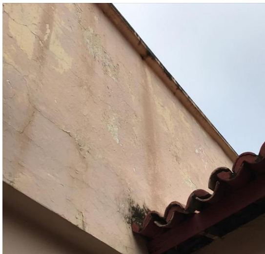
Figura 12 - Patologias na alvenaria do reservatório superior.
