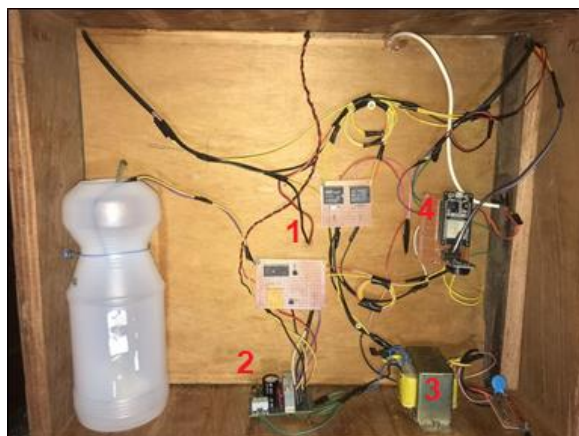
Figura 41: Acomodação dos circuitos.
