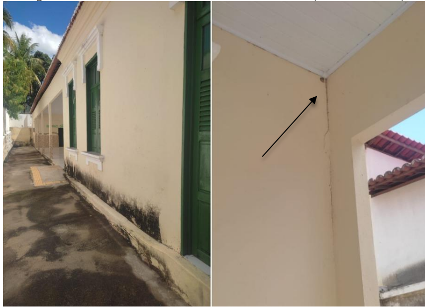
Figura 40: Detalhamento sobre umidade e rachaduras (Casa de Cultura)
