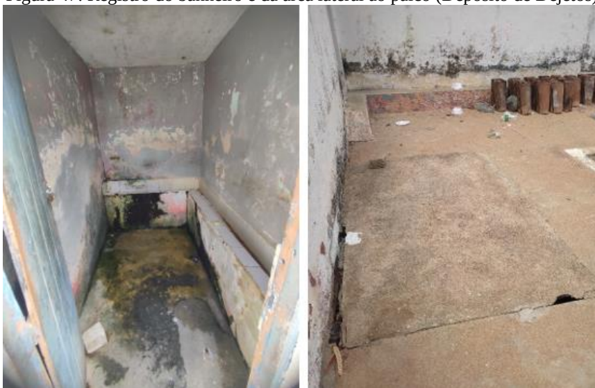
Figura 47: Registro do banheiro e da área lateral ao palco (Depósito de Dejetos)
