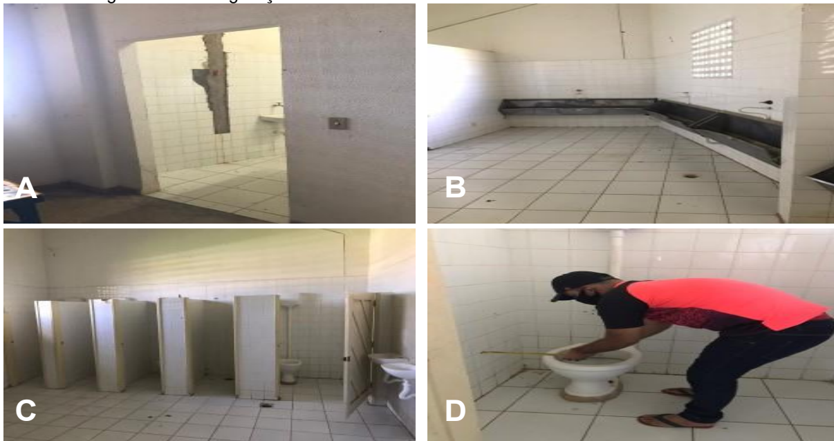
Figura 36 - Configuração e realidade do banheiro usado também como vestiário.
