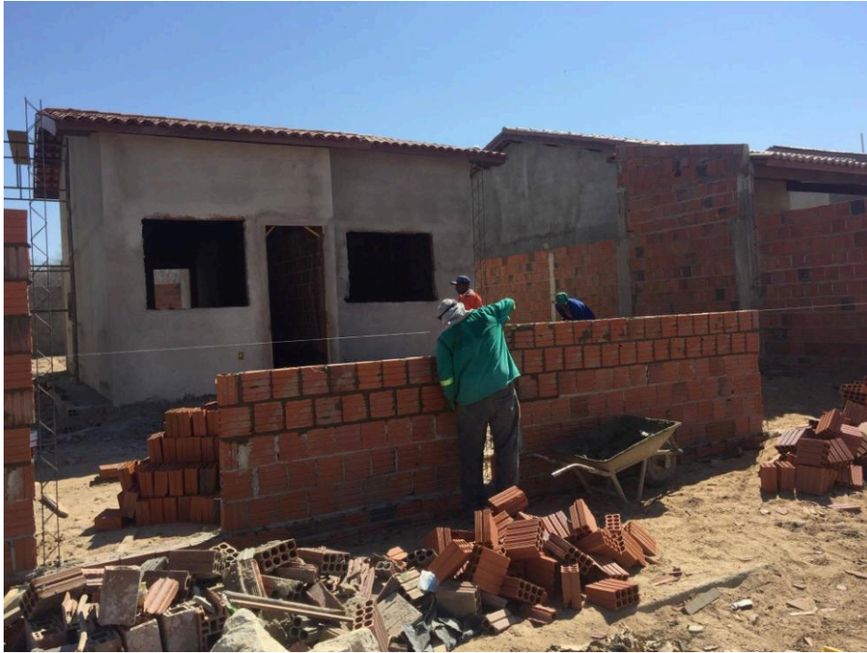
Figura 12: Desorganização no canteiro de obras
