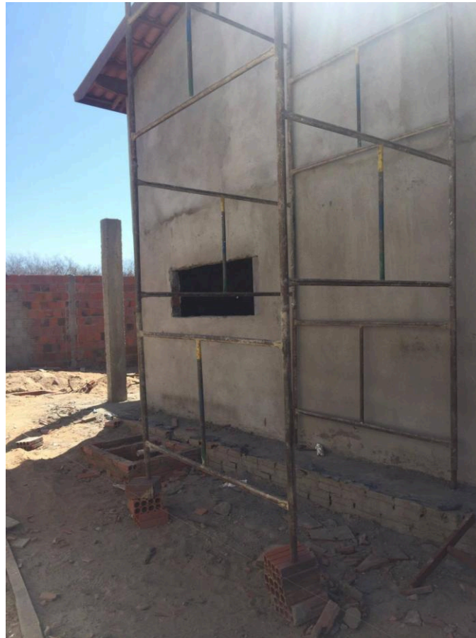
Figura 10: Nivelamento do andaime improvisado com tijolos.
