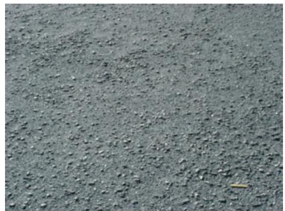
Figura 29 – Ex. 2 de desgaste no pavimento.
