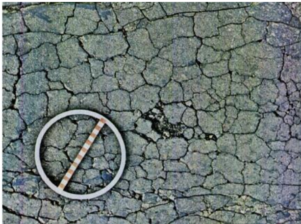
Figura 03 – Ex. 1 trinca tipo couro de jacaré.
