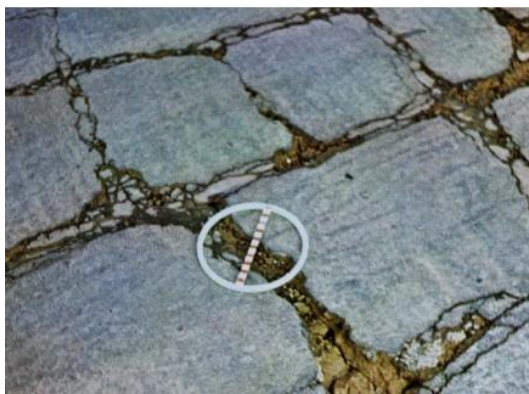
Figura 05 – Ex. 1 trinca tipo bloco.
