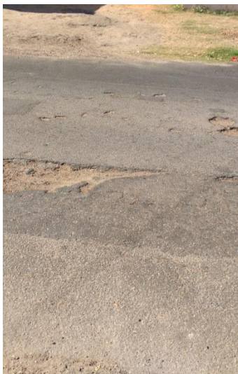
Figura 43 – Painéis no rolamento da Seção 16.
