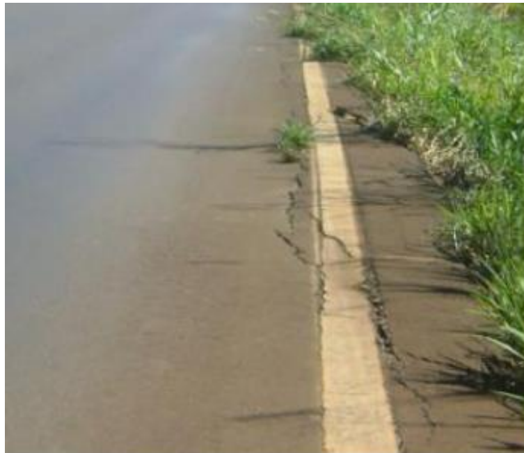
Figura 07 – Trinca nos bordos.
