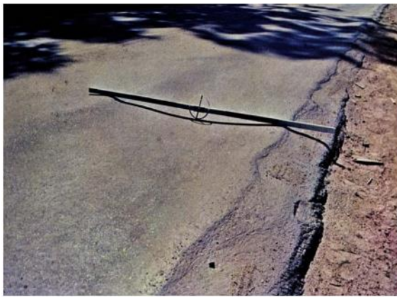
Figura 18 – Ex. 1 afundamento permanente.
