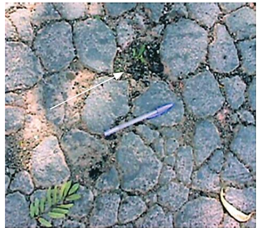
Figura 04 – Ex. 2 trinca tipo couro de jacaré.
