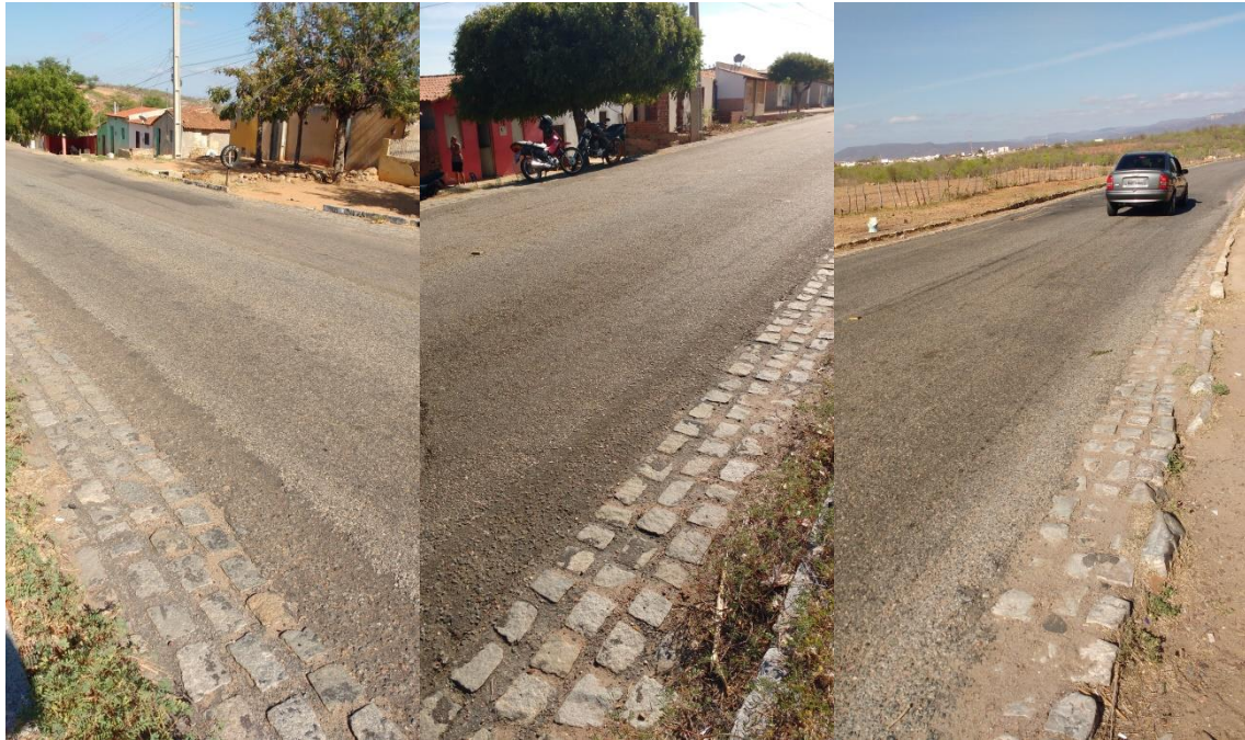
Figura 45 – Seções que necessitam de manutenção.
