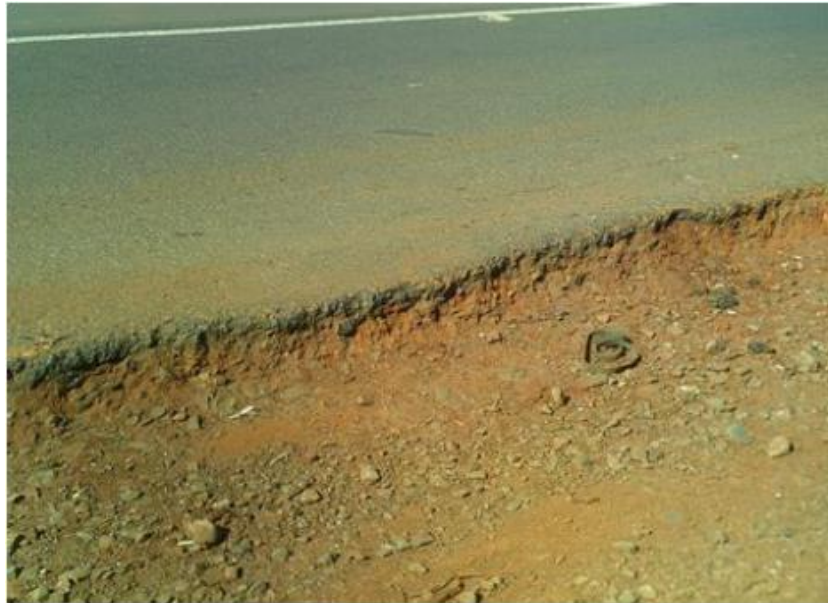
Figura 30 – Desnível entre pavimento e acostamento.
