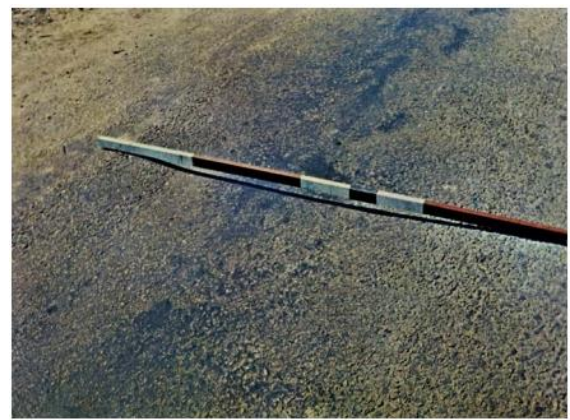
Figura 19 – Ex. 2 afundamento permanente.
