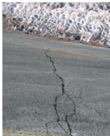
Figura 13 – Trinca de retração.
