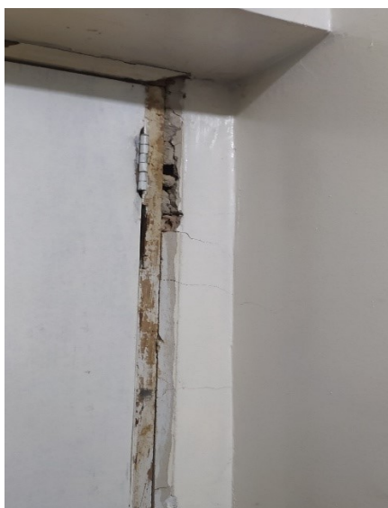
Figura 31: Degradação de esquadrias do RH
