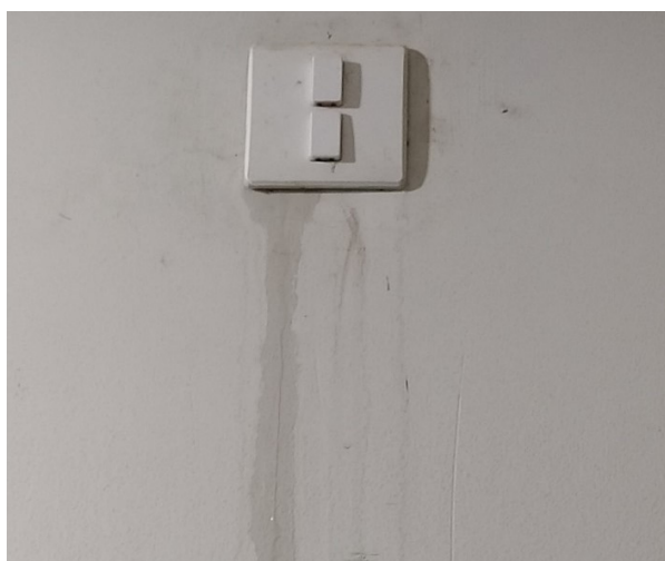
Figura 23: Fluxo de água jorrando em caixa de passagem de condutores eletricos
