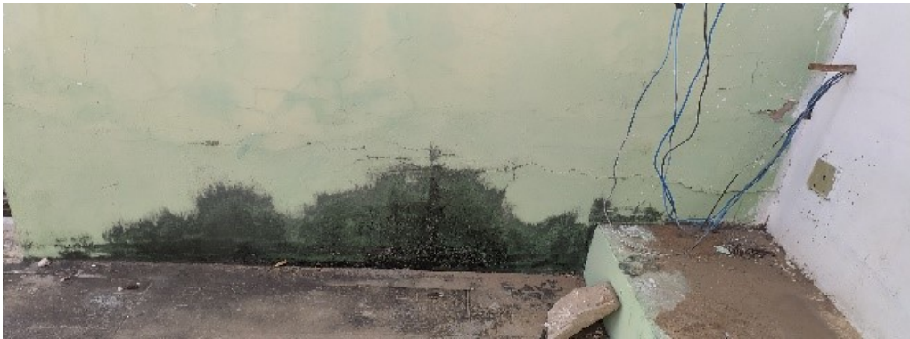
Figura 12:Bolor oriundo do transbordamento de reservatório
