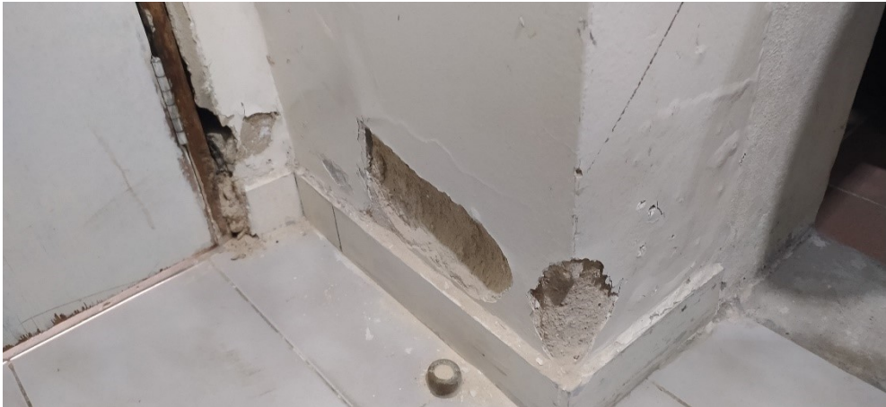
Figura 28: Descolamento de reboco na sala DTI
