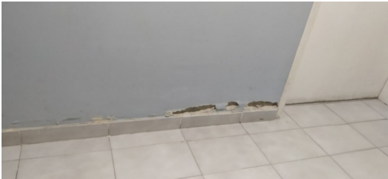
Figura 24: Esfarelamento da parede do corredor lado direito
