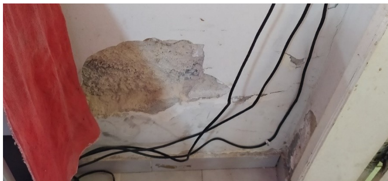
Figura 27: Descolamento de reboco sala de recursos humanos
