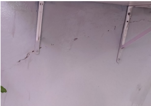
Figura 5: Fissura diagonal em parede
