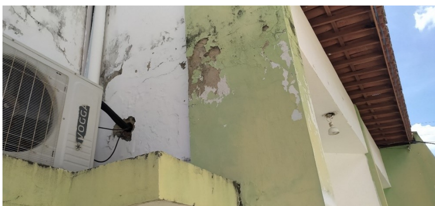
Figura 18: Esfarinhamento e descolamento de pintura
