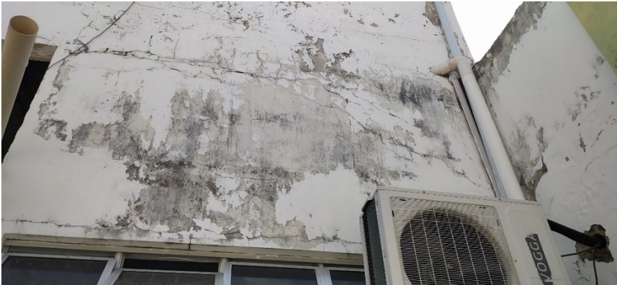
Figura 19: Esfarinhamento e descolamento de pintura
