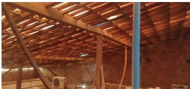
Figura 35: : Escora de madeira altamente deformada
