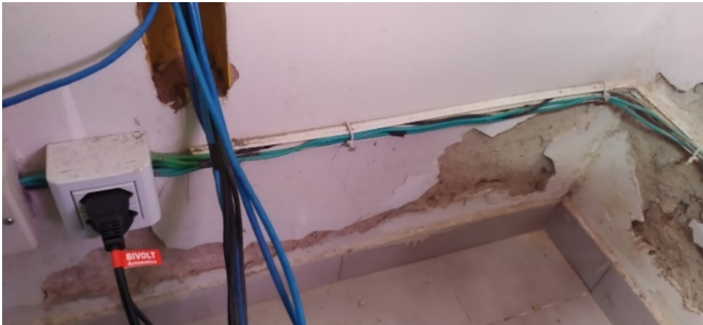
Figura 29: Esfarelamento do reboco na sala DTI
