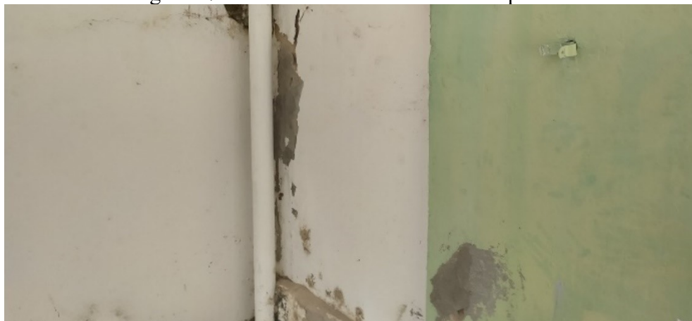
Figura 17: Manchas e descoloramento de pintura
