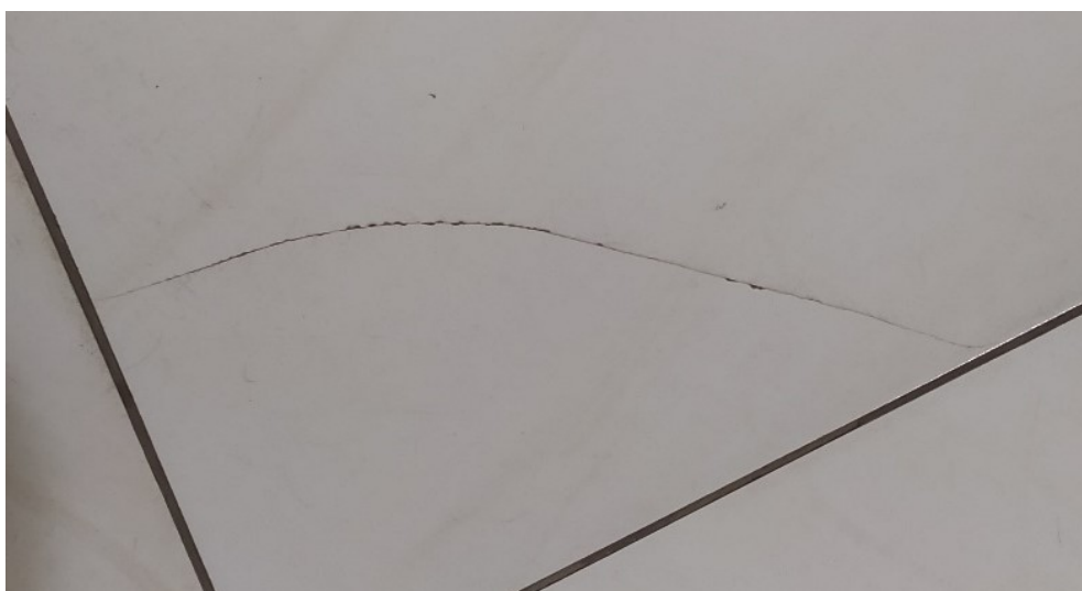
Figura 8: Fissuras na sala da Secretaria de agricultura causado por impacto
