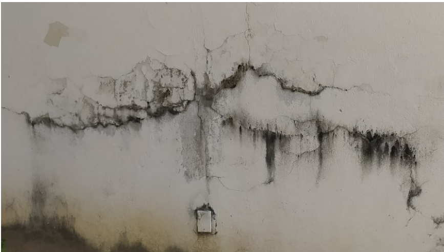
Figura 9: Bolor nas fissuras
