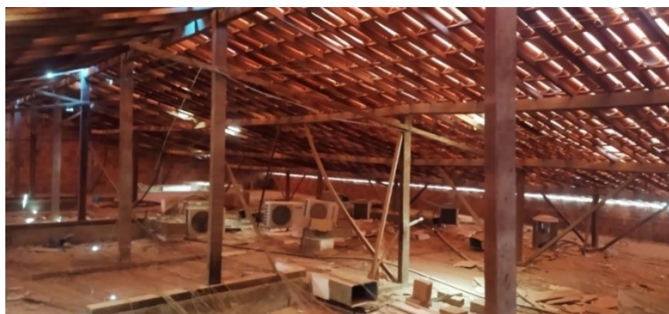
Figura 36: Fios estendidos, entulhos e material solto
