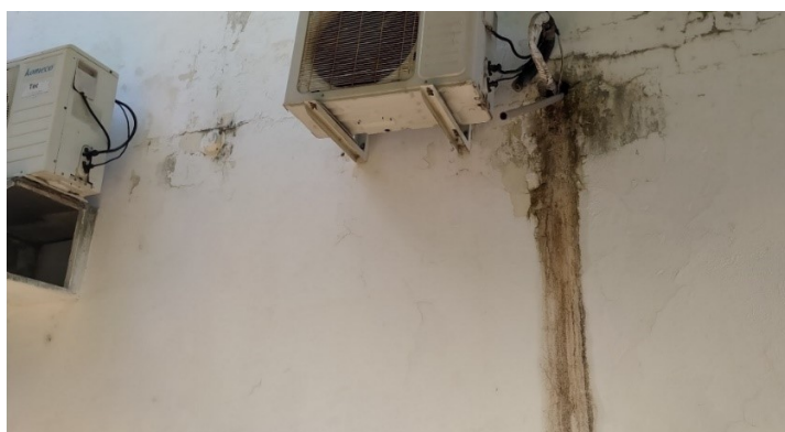
Figura 20: Manchas na pintura em virtude de instalação incorreta de ar-condicionado
