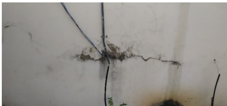
Figura 21: Saida irregular de cabos de internet, aterramento e condutores
