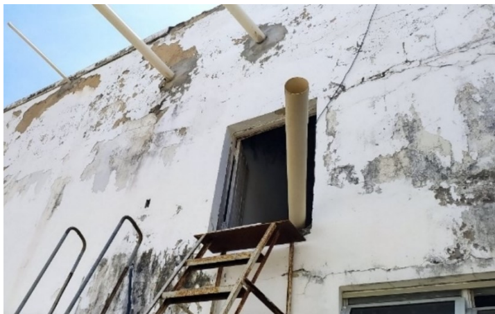
Figura 15: Esfarinhamento e descolamento de pinturas
