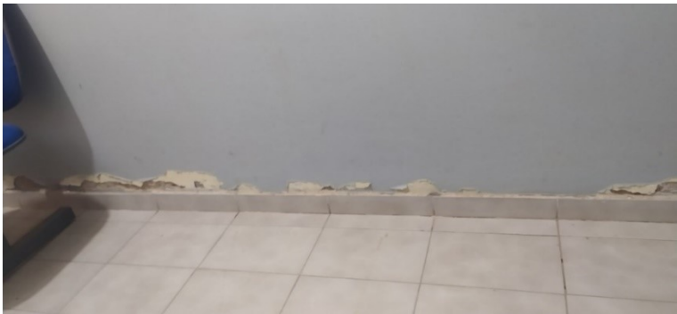
Figura 25: Esfarelamento da parede do corredor lado esquerdo
