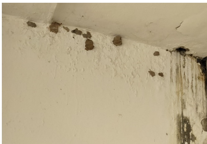
Figura 13:Eflorescência parede externa banheiro feminino
