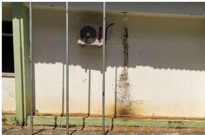
Figura 22: Umidade devido instalação de ar-condicionado irregular.
