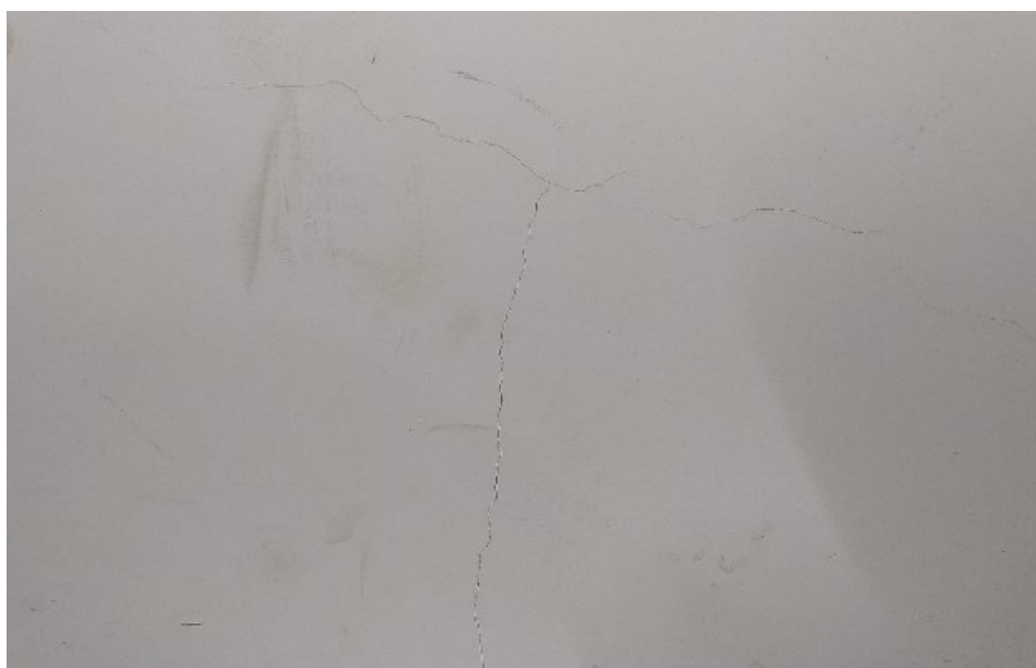
Figura 6:Fissura provocado por vibrações
