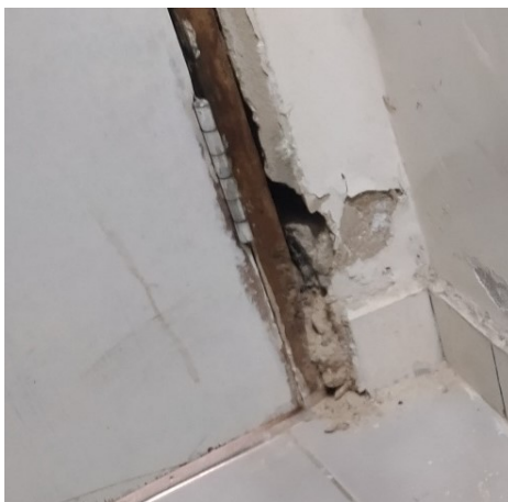
Figura 30: Degradação de esquadria do DTI
