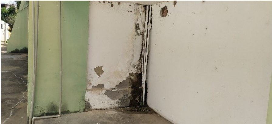
Figura 11:Bolor devido vazamento
