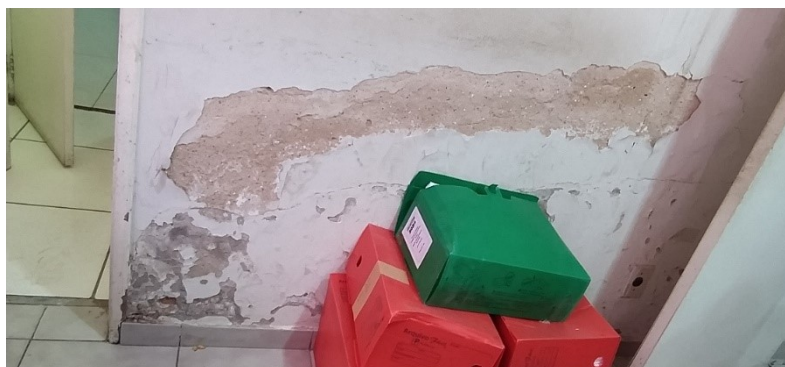
Figura 26: Esfarelamento do reboco sala de recursos humanos
