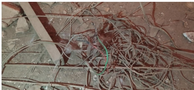
Figura 37: Fios solto e sem isolamentos
