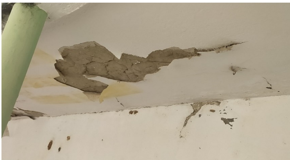
Figura 16: Descolamento de pinturas
