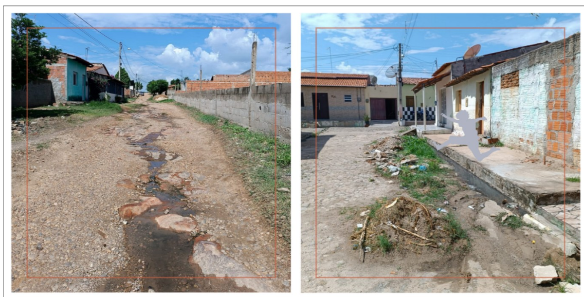
Figura 42 – Rua Não Pavimentada e Sem Manutenção
