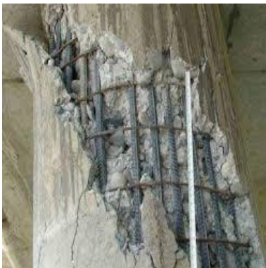
Figura 6– Falhas de concretagem
