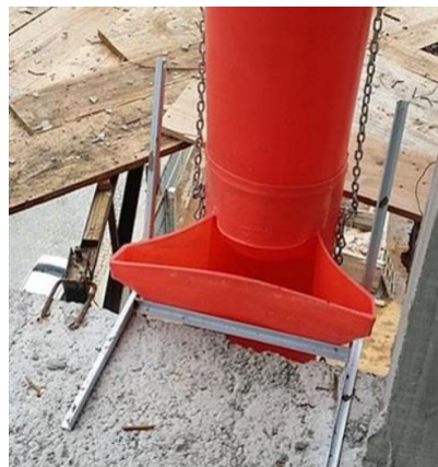
Figura 33: Duto condutor de entulho
