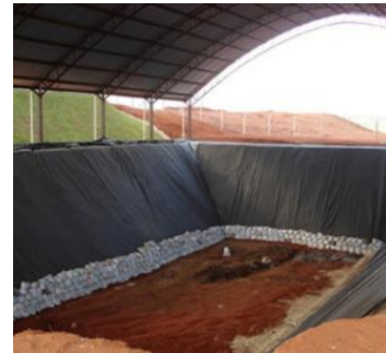
Figura 54: Aterro para resíduos industriais Classe II
