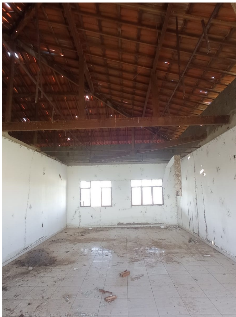
Figura 20 – Telhado danificado do CCDI
