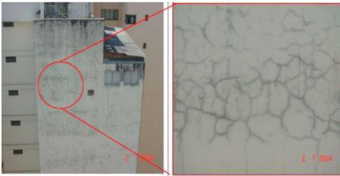
Figura 5 – Fissuras Mapeadas ou Disseminadas
