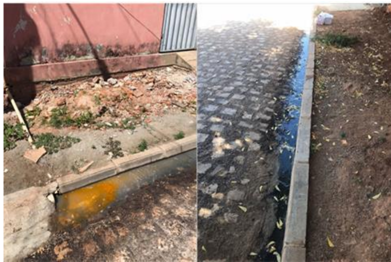
Figura 10. Esgoto a céu aberto no bairro Aeroporto I, Mossoró/RN.
