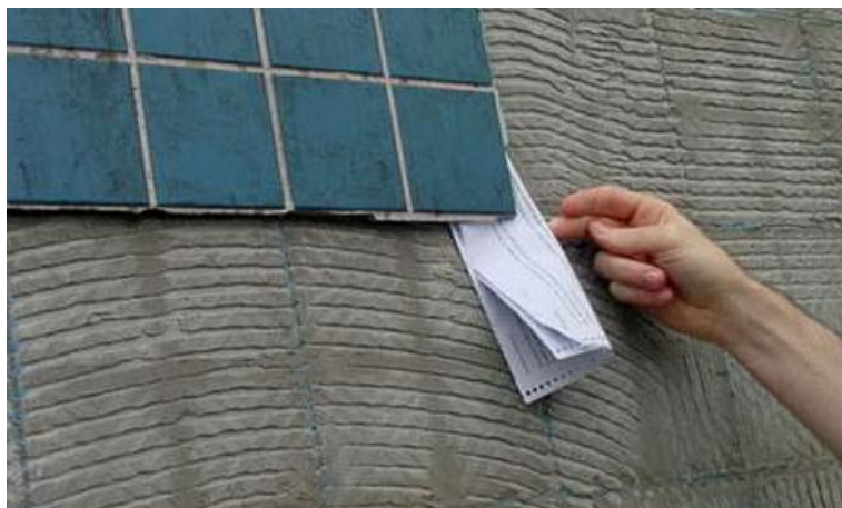
Figura 6: Desplacamento de revestimento cerâmico
