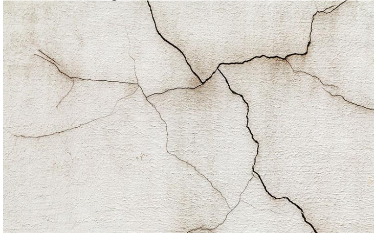
Figura 5: Trincas e Fissuras
