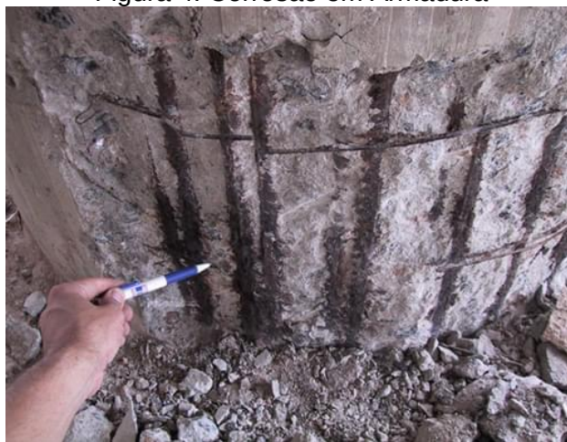
Figura 4: Corrosão em Armadura
