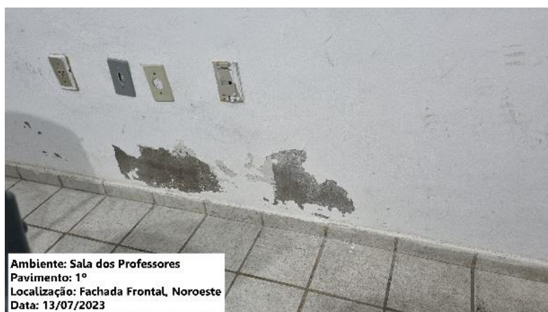
Figura 29 – Imagem de destacamento na parede da sala dos professores.
