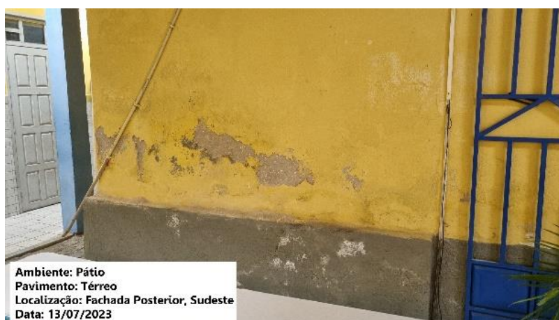
Figura 30 – Imagem de destacamento na parede do pátio (área externa).
