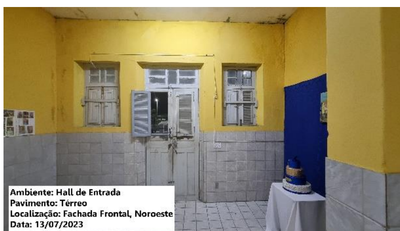
Figura 20 – Imagem de bolor no Hall de Entrada.
