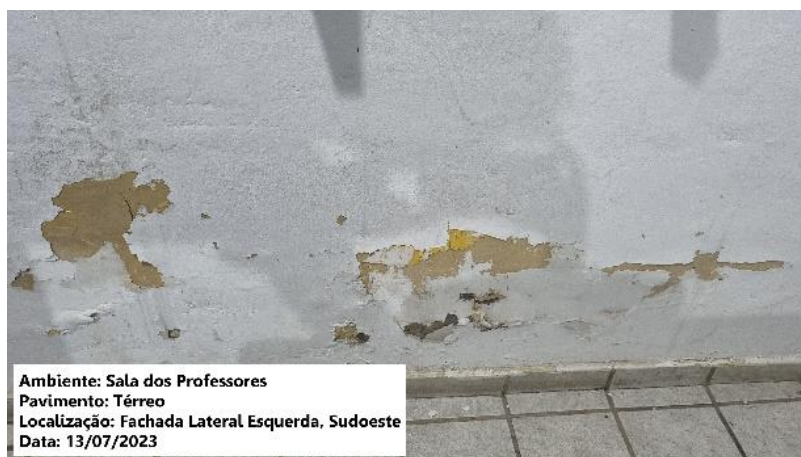
Figura 28 – Imagem de destacamento na parede da sala dos professores.
