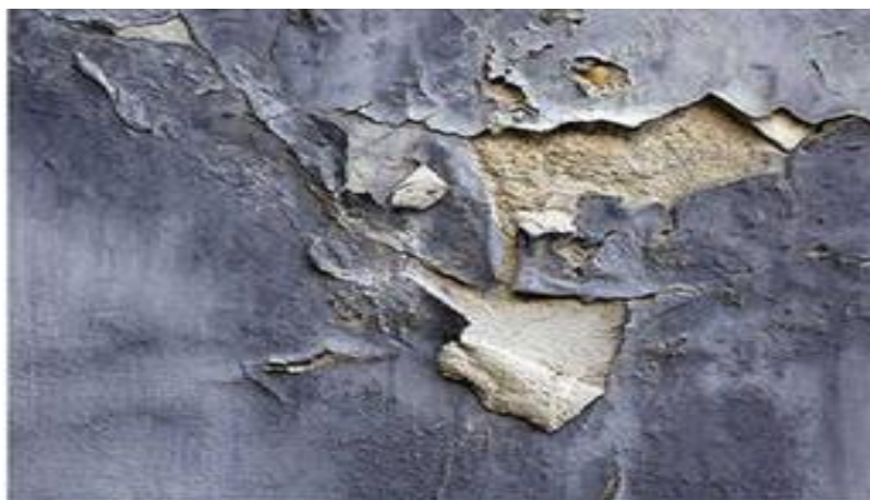
Figura 5 – Destacamento ou descolamentos
