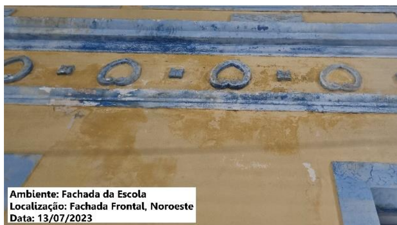
Figura 27 – Imagem de umidade na entrada da escola
