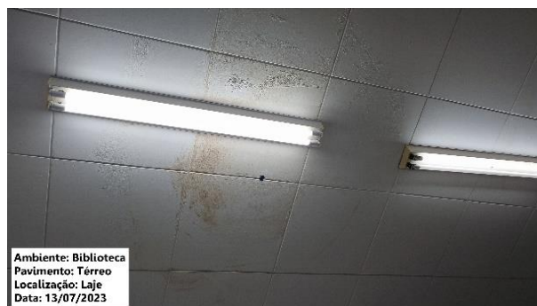
Figura 26 - Imagem de umidade no forro de gesso da biblioteca.
