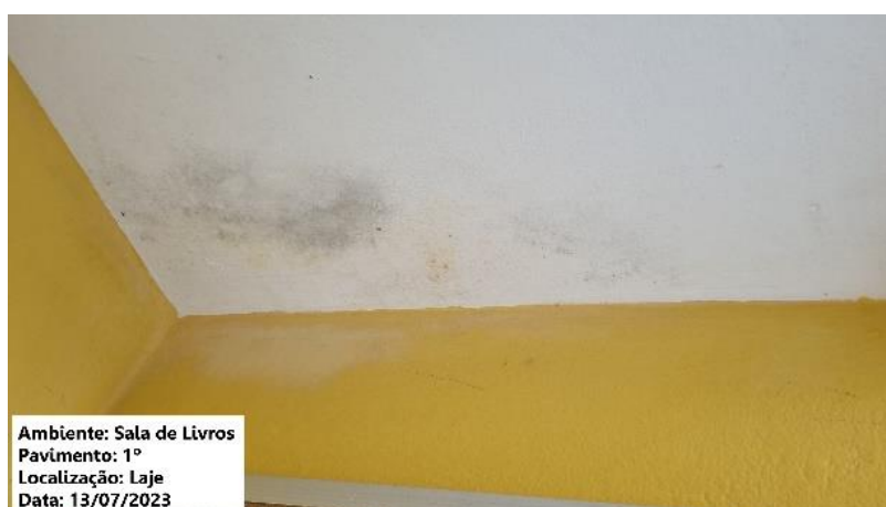
Figura 23 – Imagem de bolor na laje da sala de livros.
