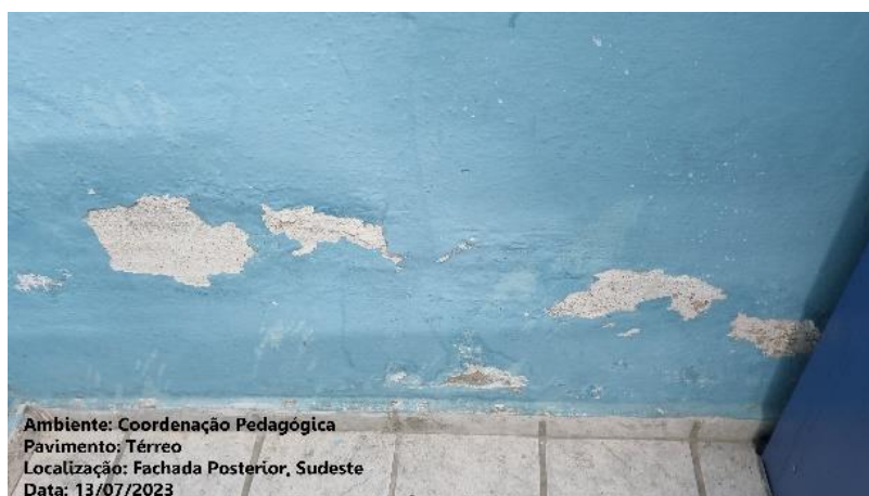
Figura 31 – Imagem de destacamento na parede da coordenação pedagógica
