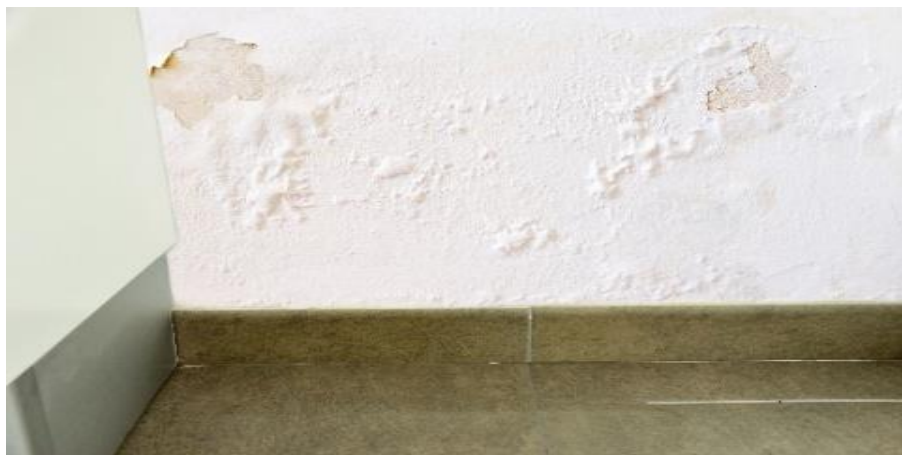
Figura 1 – Danos por umidade
