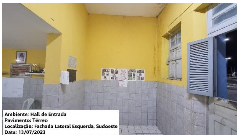
Figura 24 –Imagem de umidade na parede do hall de entrada.
