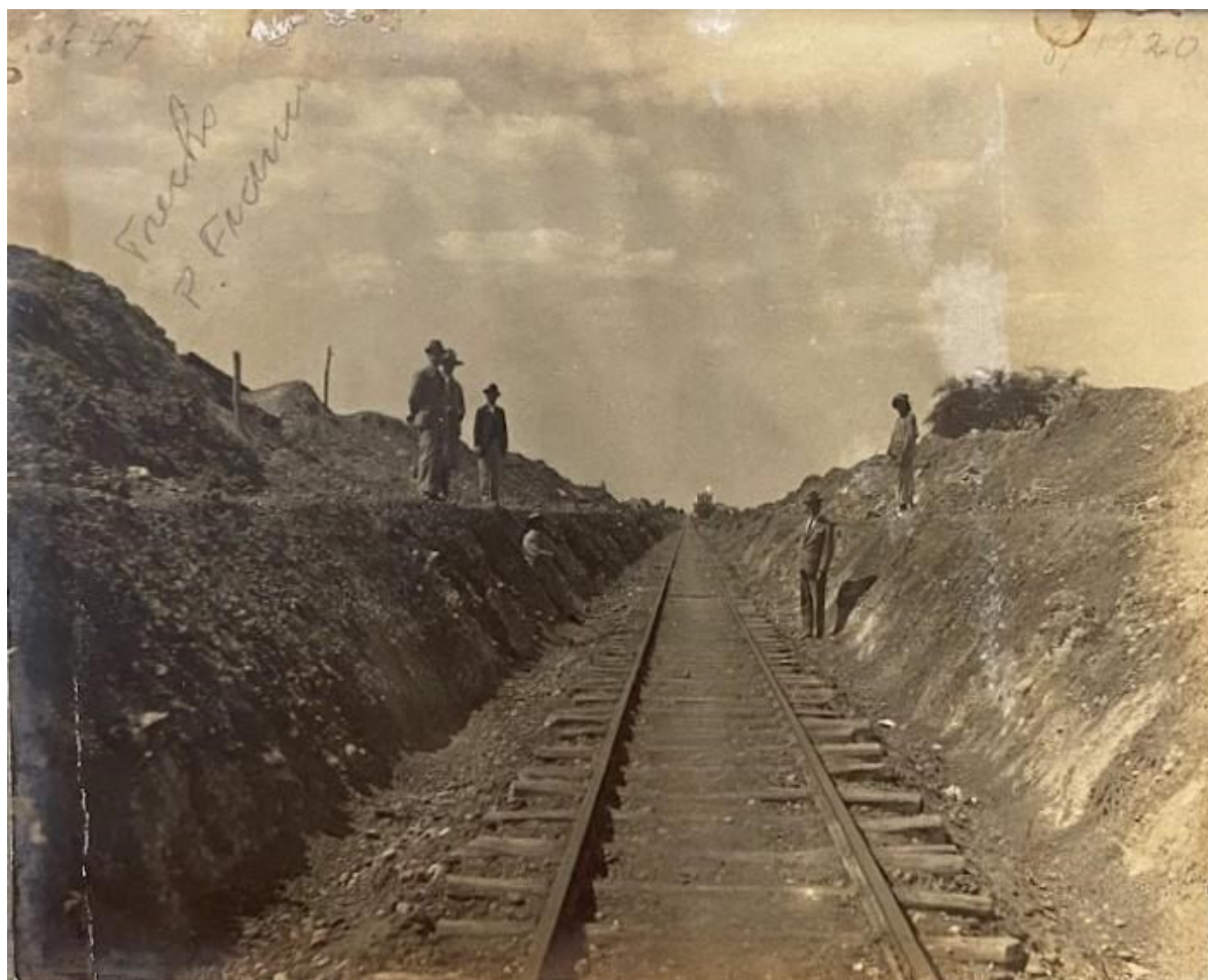
Imagem 5: Trecho Mossoró-Porto Franco em 1915
