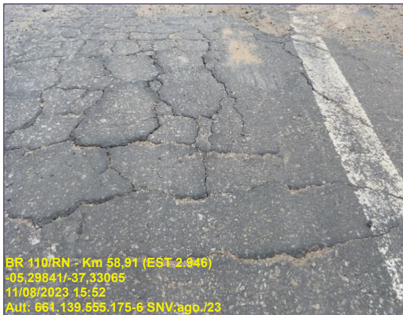
Figura 13 – Trinca Interligada tipo Bloco
