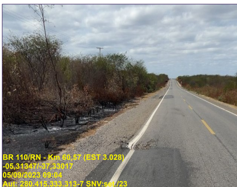
Figura 9 – Escorregamento do Revestimento Betuminoso
