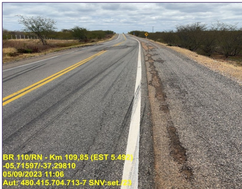
Figura 10 – Trinca Isolada Longitudinal Longa
