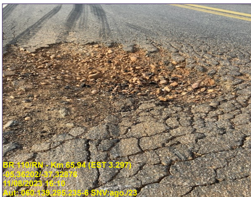
Figura 7 – Panela acompanhada de trinca tipo “Couro de Jacaré”
