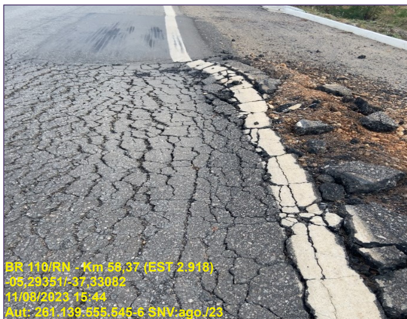
Figura 11 – Trinca Interligada tipo Couro de Jacaré
