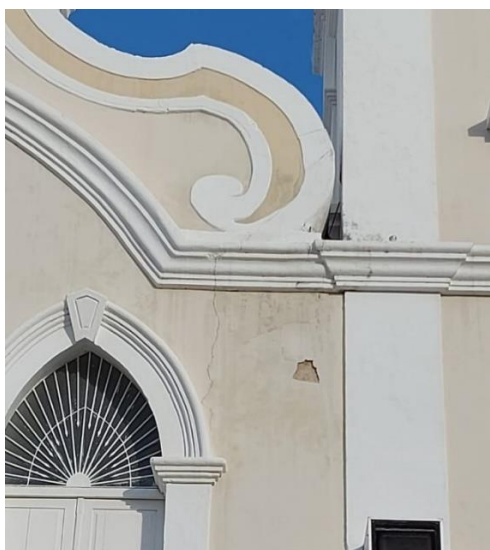
Figura 8 - Local de maior degradação da fachada principal da Igreja de Sant'Ana
