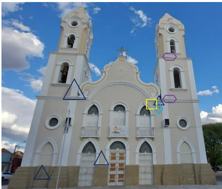
Figura 7 - Mapeamento de manifestações na fachada frontal
