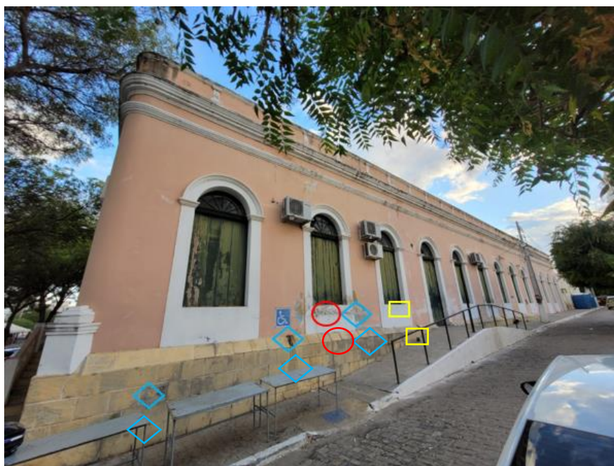
Figura 14 - Mapeamento das manifestações patológicas da fachada lateral direita
