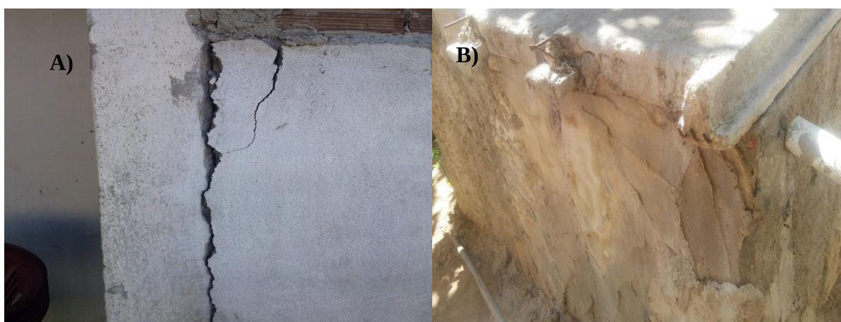
Figura 5: Rachaduras em reservatório de água proveniente das detonações realizadas pela pedreira no Município de Caraúbas-RN. A) Parte lateral de uma cisterna atingida; B) Parte superior de uma cisterna atingida.
