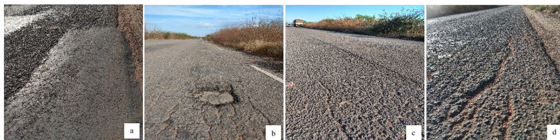
Figura 2. Remendo (a) panela (b) trinca couro de jacaré (c) trinca isolada (d). (Autoria própria)
