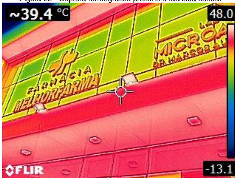
Figura 22 - Captura termográfica próximo a fachada central
