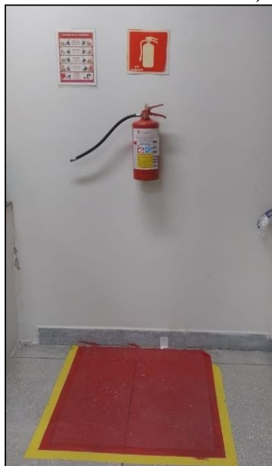
Figura 20 - Extintor de incêndio com sinalização horizontal.
