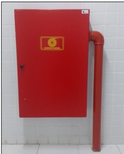
Figura 28a - Provisões contra incêndio
