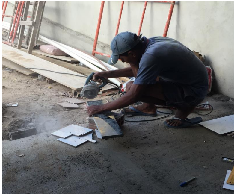
Figura 19: Falta de uso de EPIs
