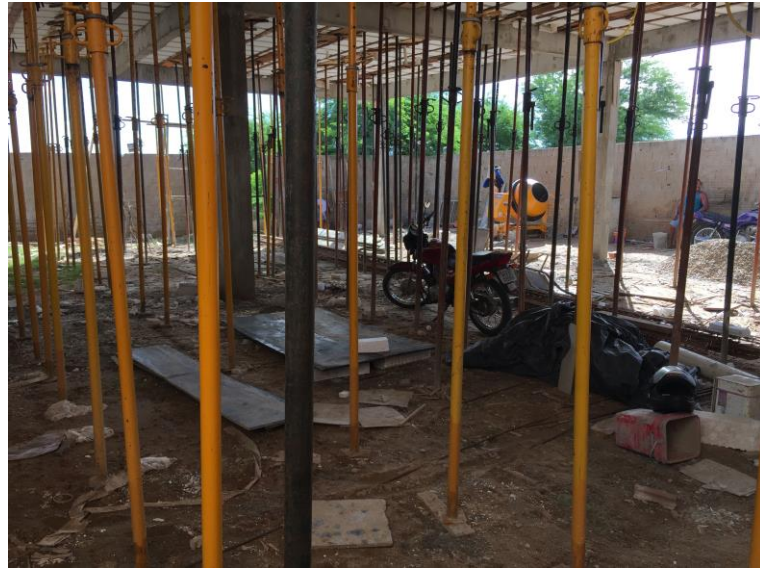
Figura 11: Motocicleta e entulhos no canteiro
