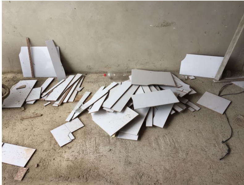
Figura 18: Desperdício de materiais cerâmicos
