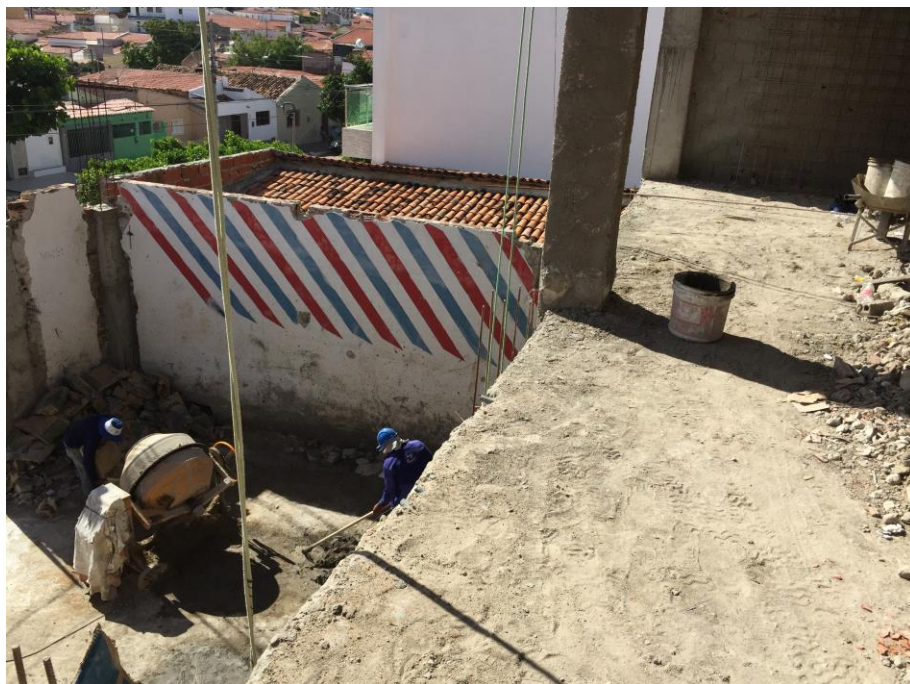
Figura 9: Ausência de sinalização e/ou proteção (guarda corpo)
