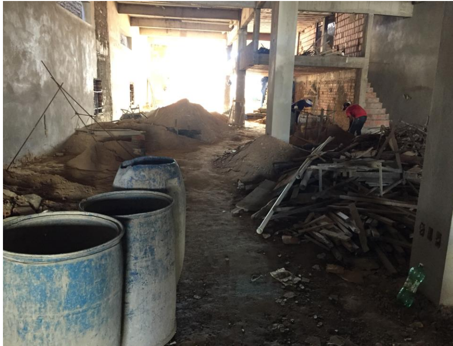
Figura 8: Desorganização no canteiro
