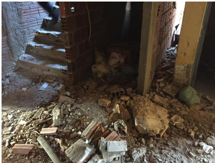
Figura 15: Entulhos na Obra D
