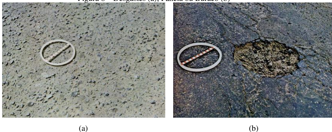
Figura 8 – Desgastes (a); Panela ou Buraco (b)
