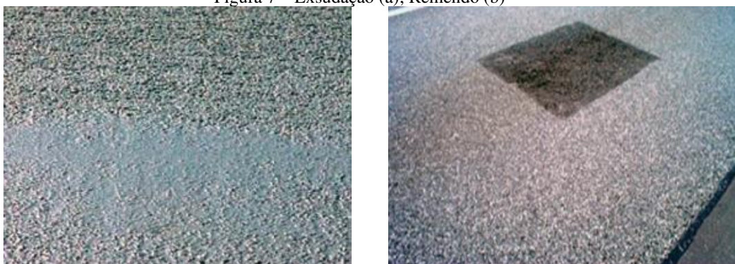
Figura 7 – Exsudação (a); Remendo (b)
