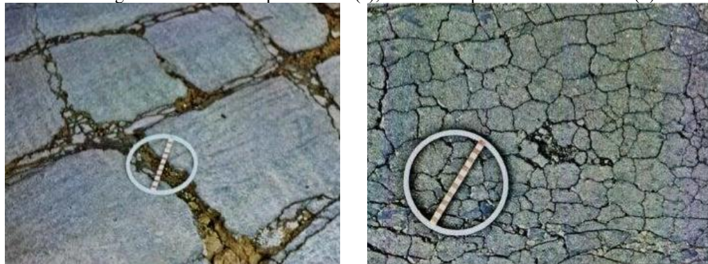
Figura 4 – Trinca do tipo “Bloco” (a); Trinca do tipo “Couro de Jacaré” (b)
