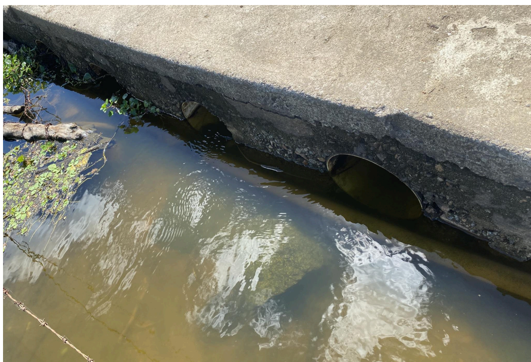
Figura 36 - Condição da travessia hidráulica de acesso ao Complexo Turístico Serrote do Jatobá e Sítio Taboleiro Grande em Pau dos Ferros/RN, evidenciando limitação da capacidade de escoamento
