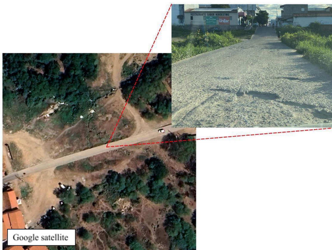
Figura 35 - Condições estruturais da passagem molhada na Rua Antônio Gurjão no Bairro São Geraldo em Pau Dos Ferros/RN, evidenciando necessidade de readequação do pavimento.
