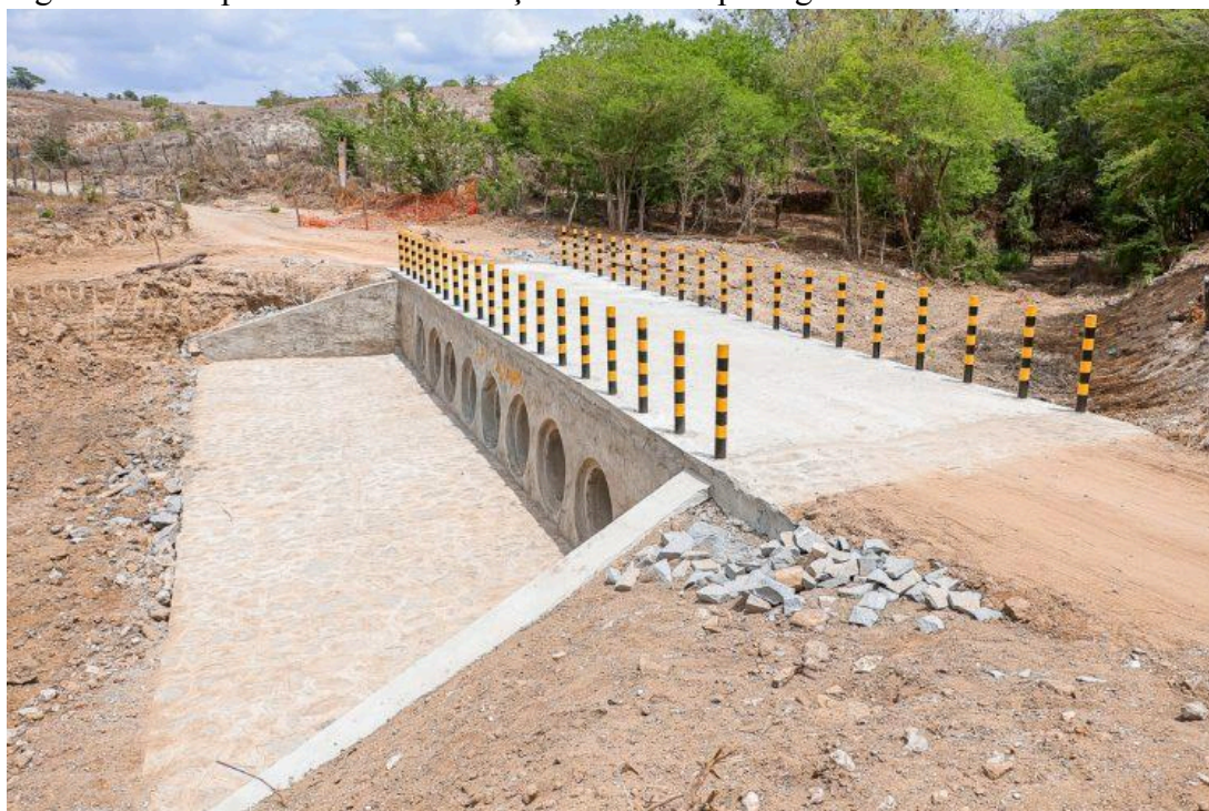
Figura 12 - Dispositivos de sinalização lateral em passagem molhada
