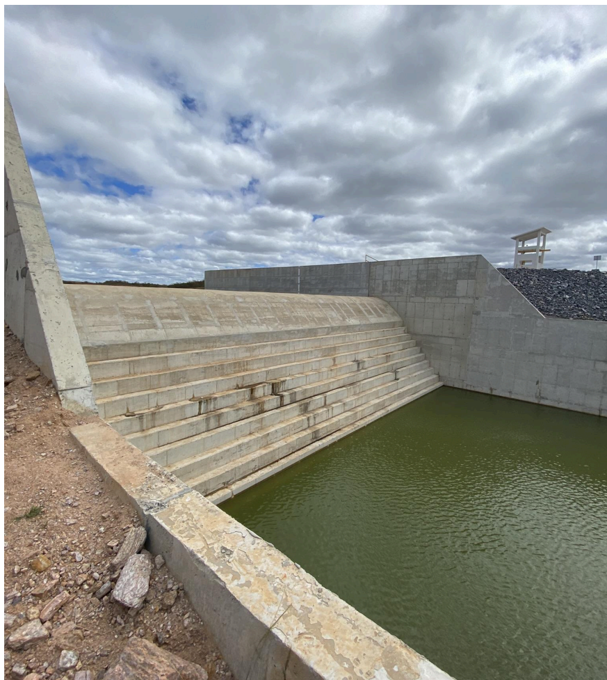
Figura 5 - Dissipador de energia em degraus na barragem do Tambor em Cachoeira dos Índios/PB
