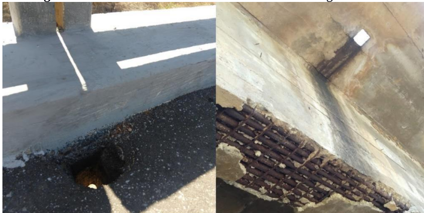
Figura 15: Problema decorrente de um sistema de drenagem ineficiente.
