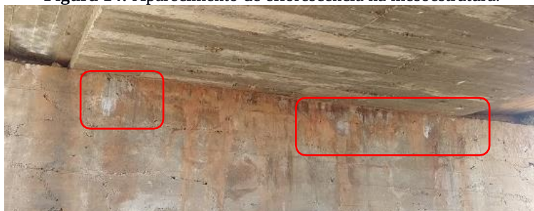
Figura 14: Aparecimento de eflorescência na mesoestrutura.
