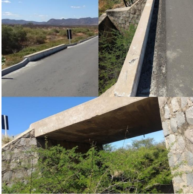
Figura 16: Perigosidade decorrente da ausência de guarda-corpo.
