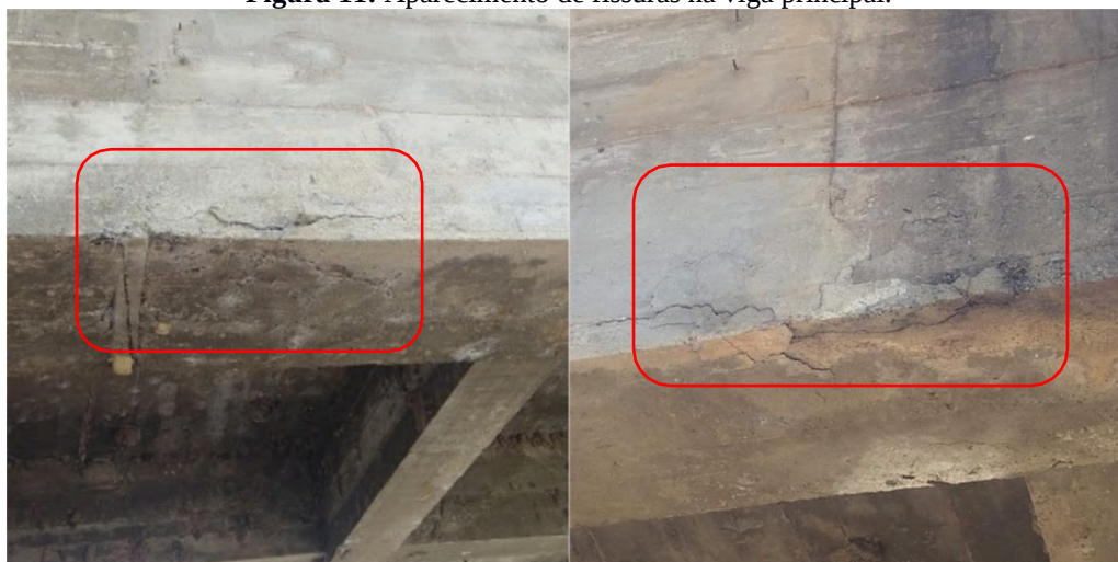
Figura 11: Aparecimento de fissuras na viga principal.
