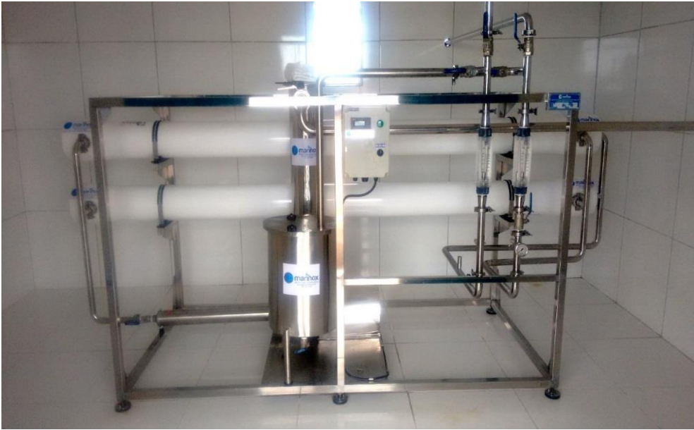
Figura 05 – Sistema de osmose reversa
