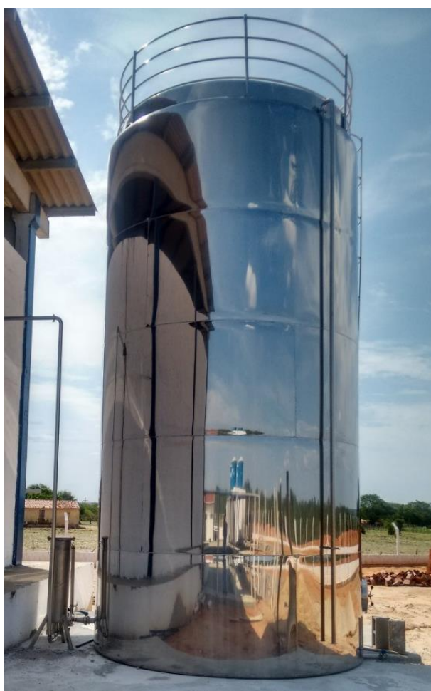
Figura 07 – Reservatório de aço inox com capacidade de 55000L
