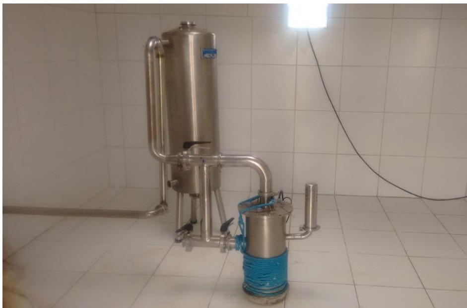
Figura 04 – Filtro e cabeça do poço
