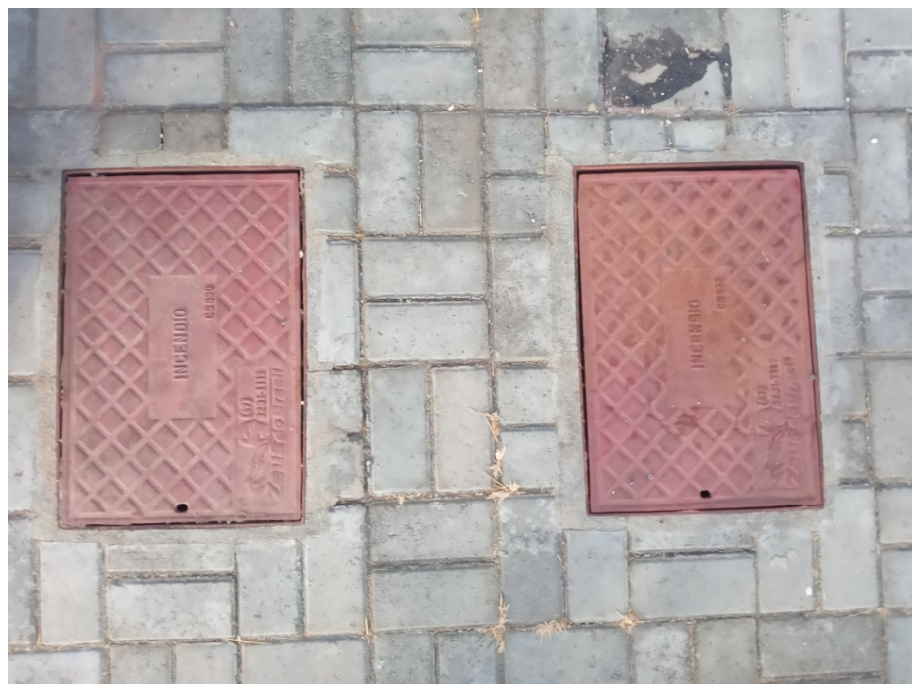
Figura 42 – Abrigos dos Registros de Recalque
