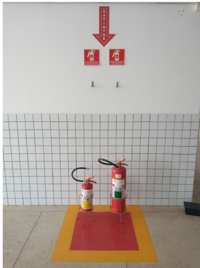
Figura 34 – Unidade extintora de incêndio
