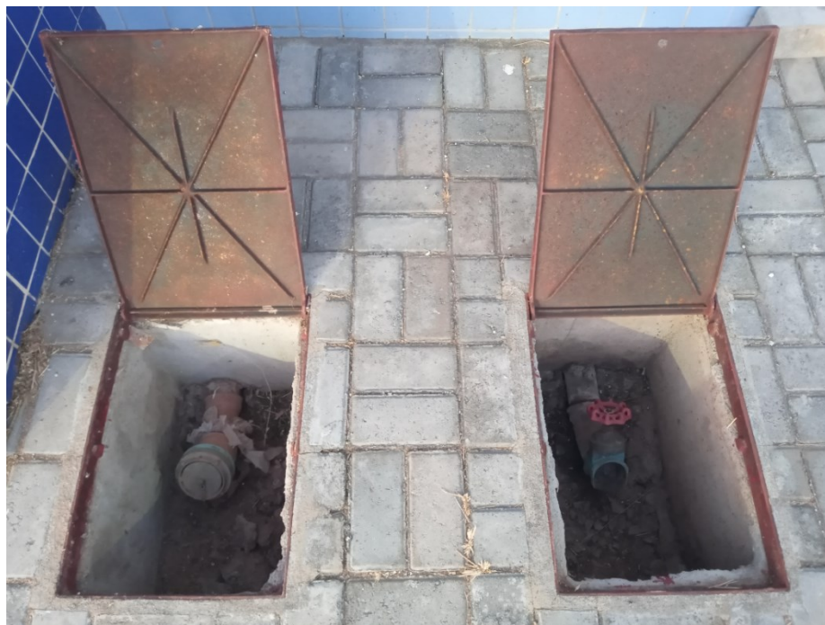
Figura 43 – Registros de Recalque dos Hidrantes e Chuveiros Automáticos
