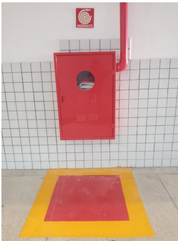
Figura 38 – Hidrante da Edificação
