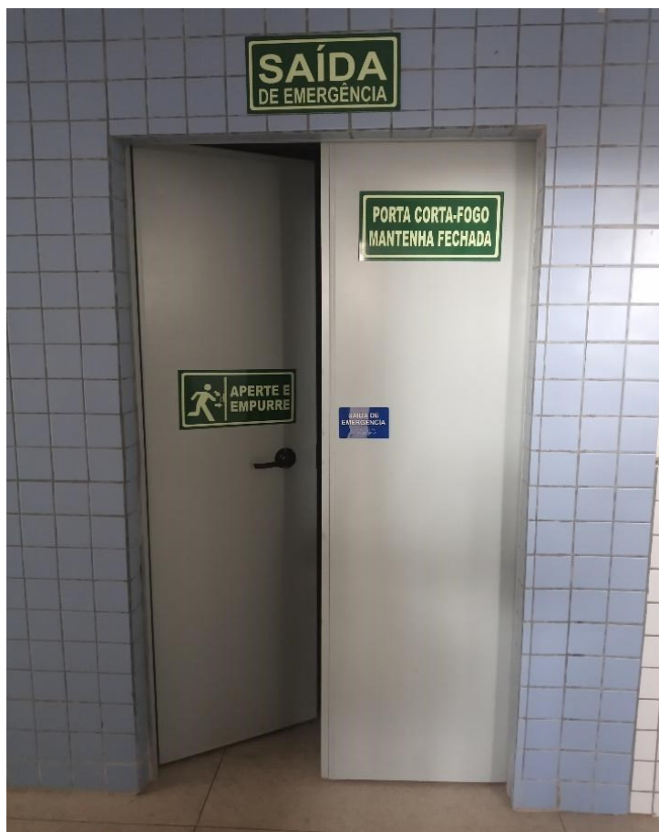
Figura 31 – Porta Corta-Fogo da Escada de Emergência
