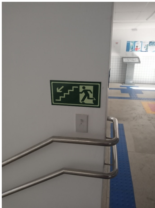
Figura 30 – Sinalização da Escada Convencional
