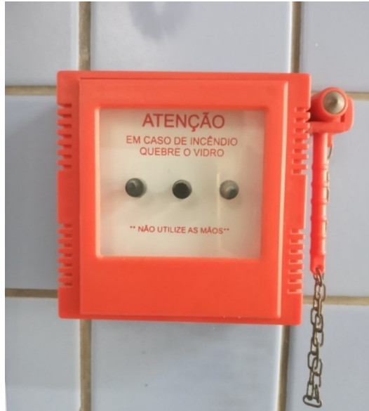
Figura 41 – Sistema de Alarme Supervisionado
