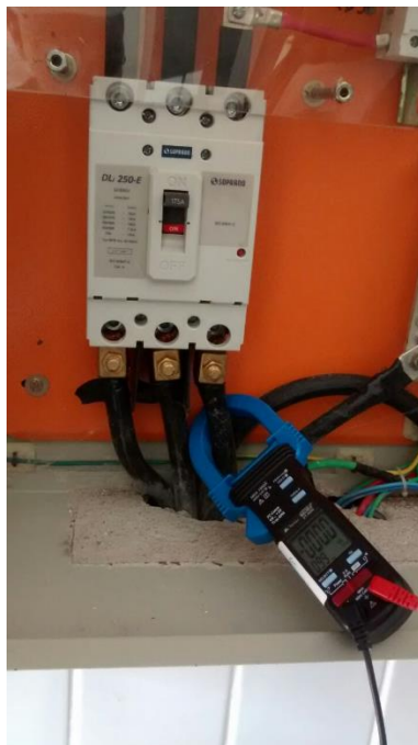
Figura 5 - Utilização de alicate wattímetro em medições de fator de potência.
