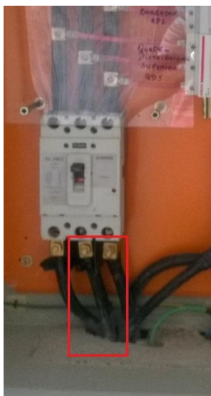
Figura 9 - Quadro de distribuição do Bloco de Sala II.
