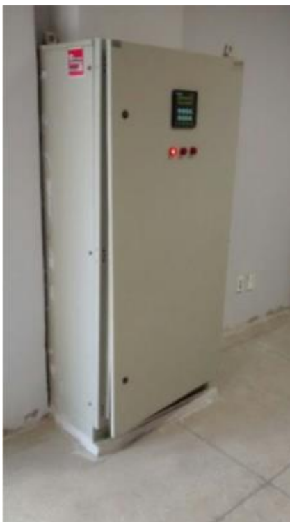
Figura 6 - Quadro de energia do bloco administrativo.
