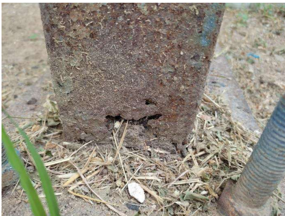
Figura 15: Impurezas e corrosão por frestas na base do pilar.
