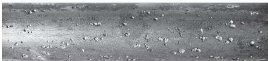
Figura 5: Corrosão por pite em tubo de aço inoxidável.
