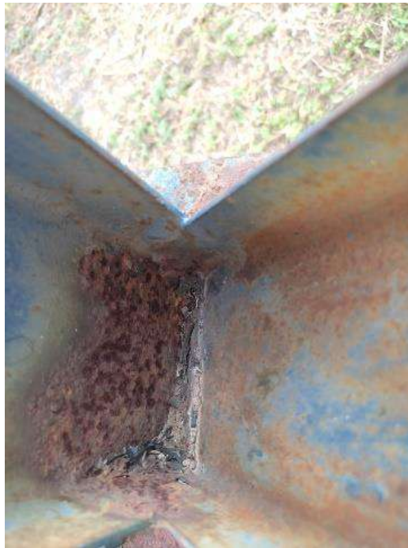
Figura 19: Falha no cordão de solda.
