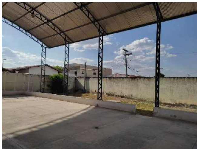
Figura 18: Falta das grades laterais.
