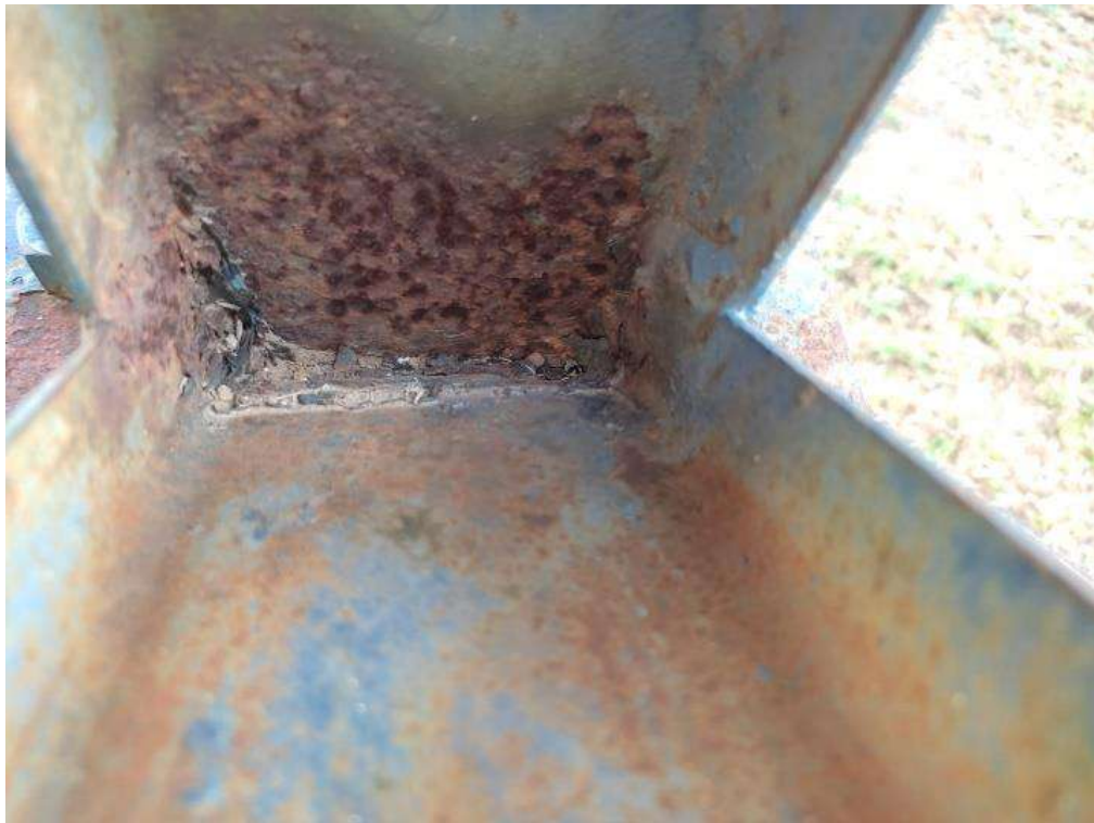
Figura 17: Corrosão por pite em pilar da estrutura metálica.
