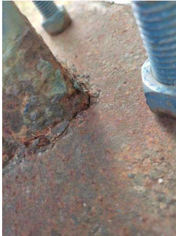
Figura 16: Impurezas e corrosão por frestas na base do pilar.
