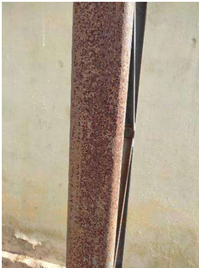
Figura 14: Corrosão uniforme no pilar da estrutura metálica.
