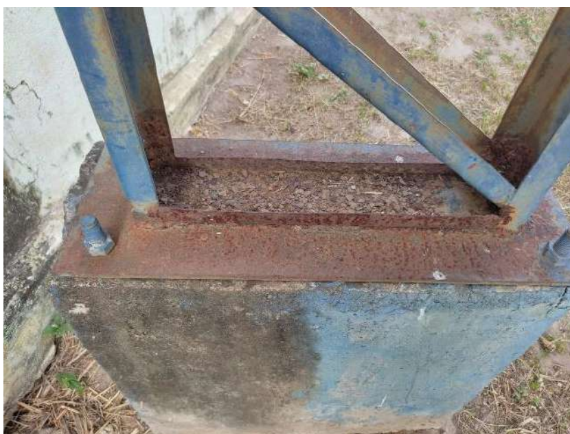
Figura 13: Corrosão uniforme no pilar da estrutura metálica.
