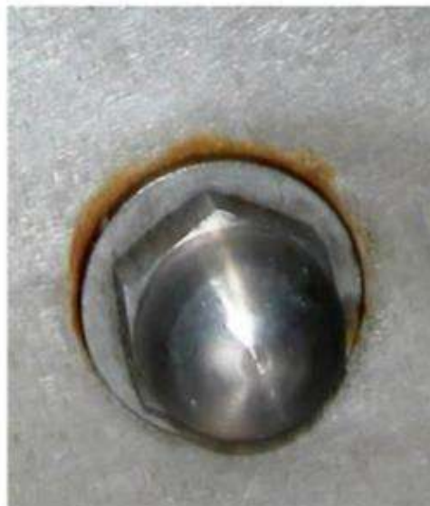
Figura 4: Corrosão por fresta sob a cabeça de um parafuso.
