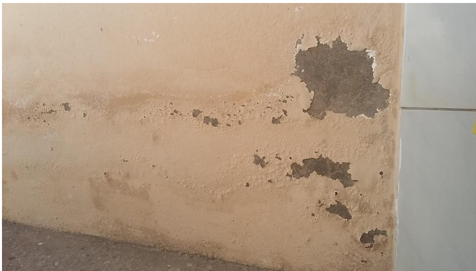
Figura 6 – Manifestação patológica causada pela umidade na alvenaria.
