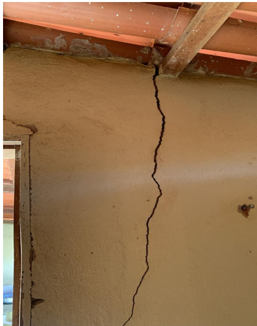
Figura 6 - Aparecimento de fissura
