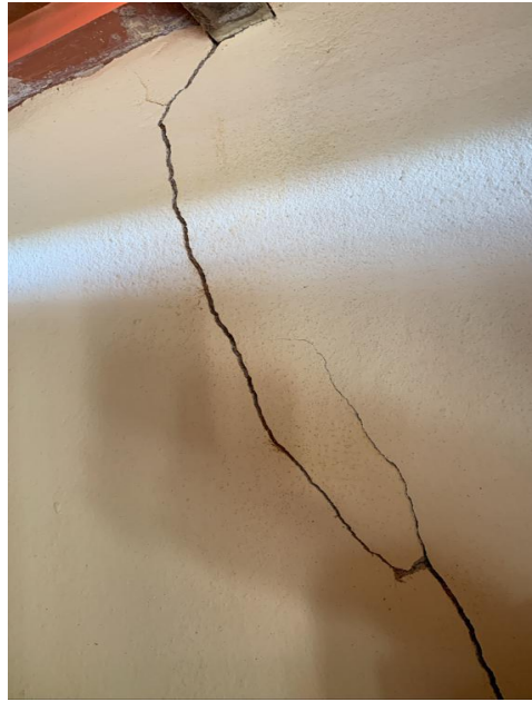
Figura 5 - Presença de fissura
