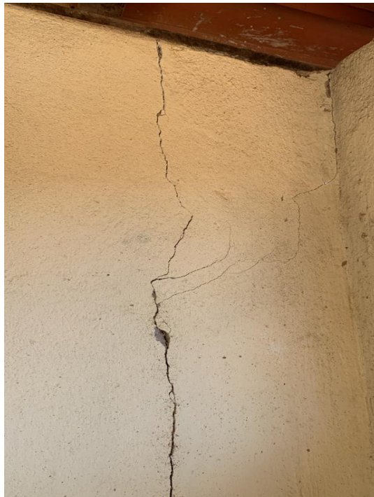
Figura 8 - Fissura em residência
