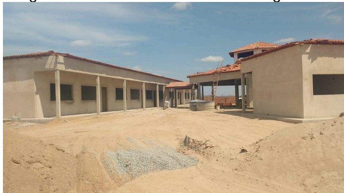
Figura 7 – Canteiro de obra sem abrigos
