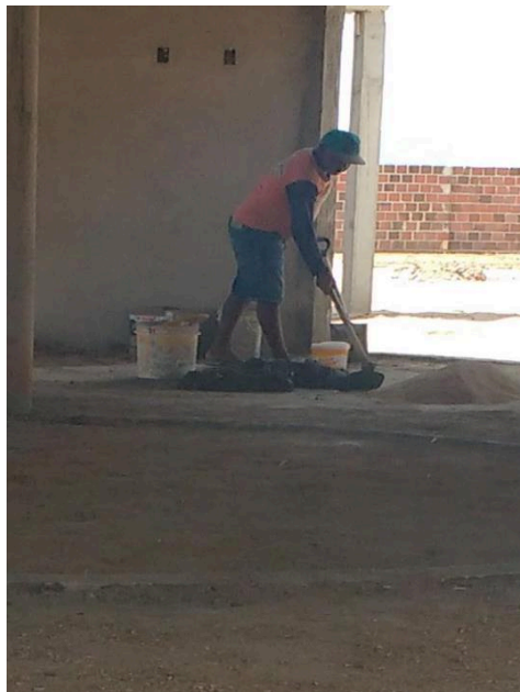
Figura 4 – Trabalhador sem EPIs
