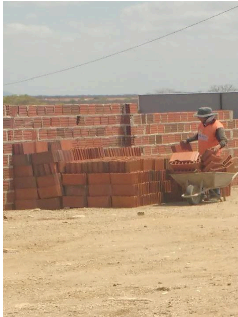
Figura 3 – Ausência de EPIs
