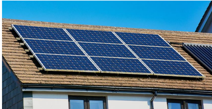
Figura 10 – Placas de energia solar
