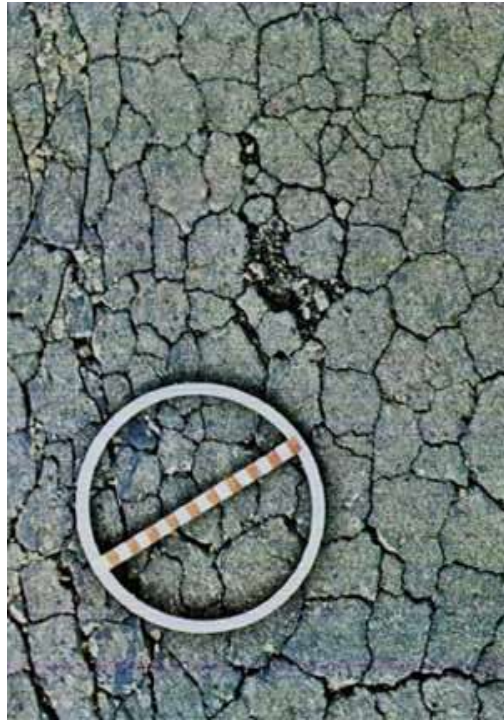
Figura 6 – Trinca interligada tipo jacaré
