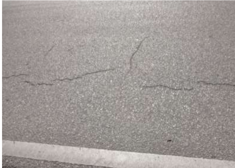
Figura 18 – Trincas longitudinais e transversais.
