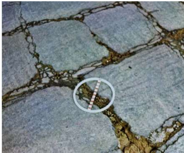
Figura 7 – Trinca interligada tipo bloco.
