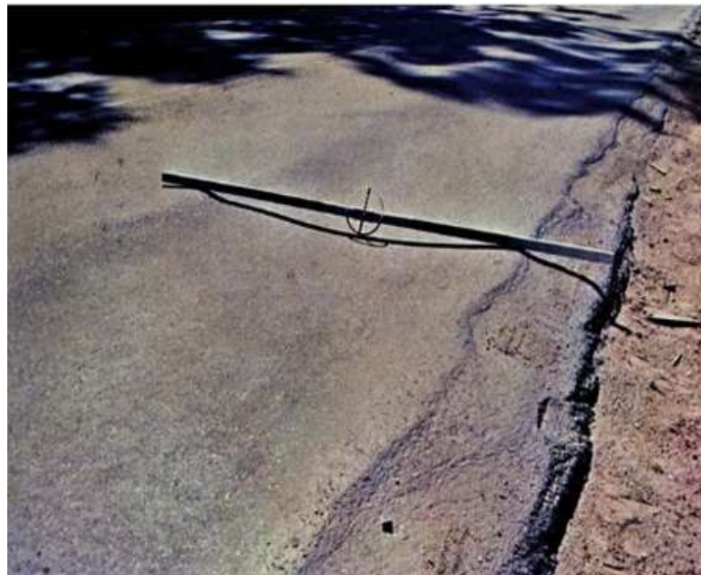
Figura 8 – Afundamento de trilha de roda
