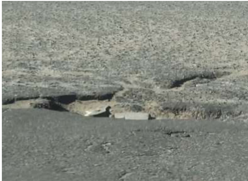
Figura 30 – Defeito tipo Panela com a presença de desgaste
