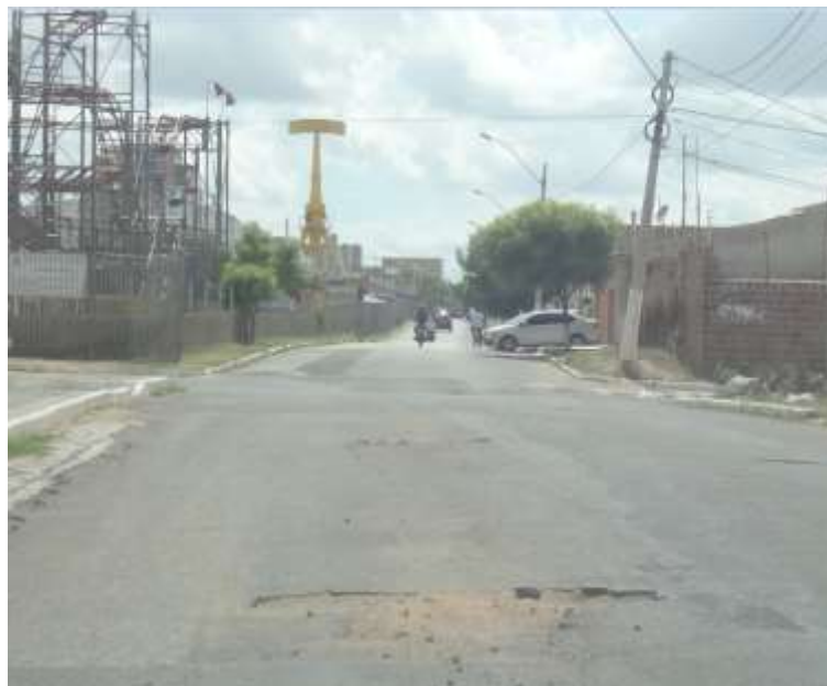
Figura 29 – Defeito tipo Panela
