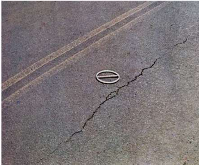
Figura 5 – Trinca isolada longitudinal
