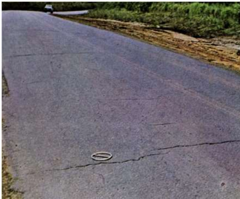
Figura 4 – Trinca isolada transversal
