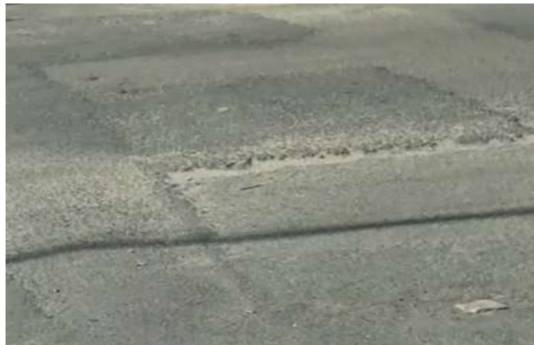
Figura 29 – Defeito tipo Remendo
