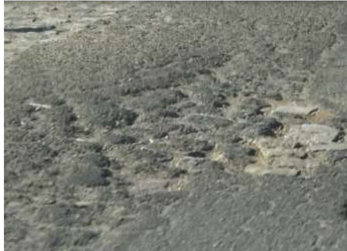
Figura 30 – Defeito do tipo Trinca “Couro de Jacaré”
