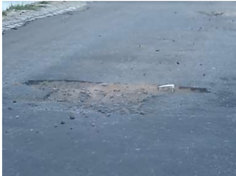
Figura 28 – Defeito tipo Panela
