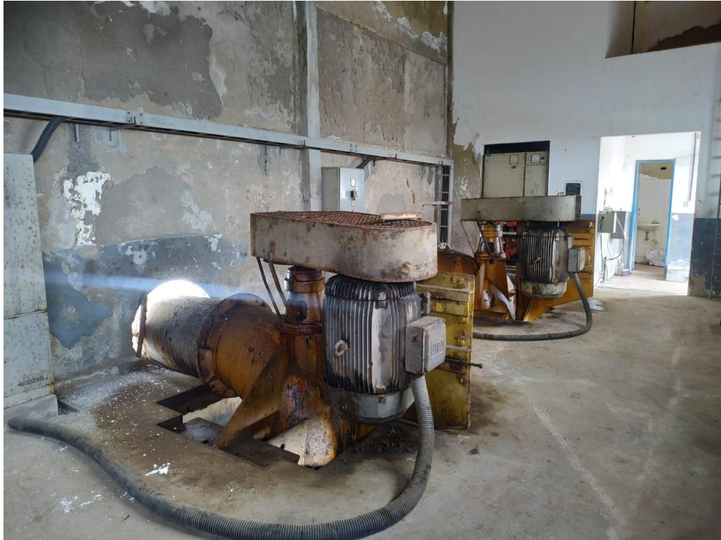
Figura 33: Bombas da central elevatória (08, 09, 10)
