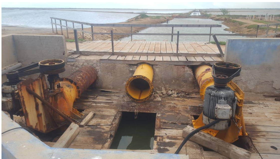
Figura 30: Bombas do furado (da esquerda para a direita 03, 04 e 05)
