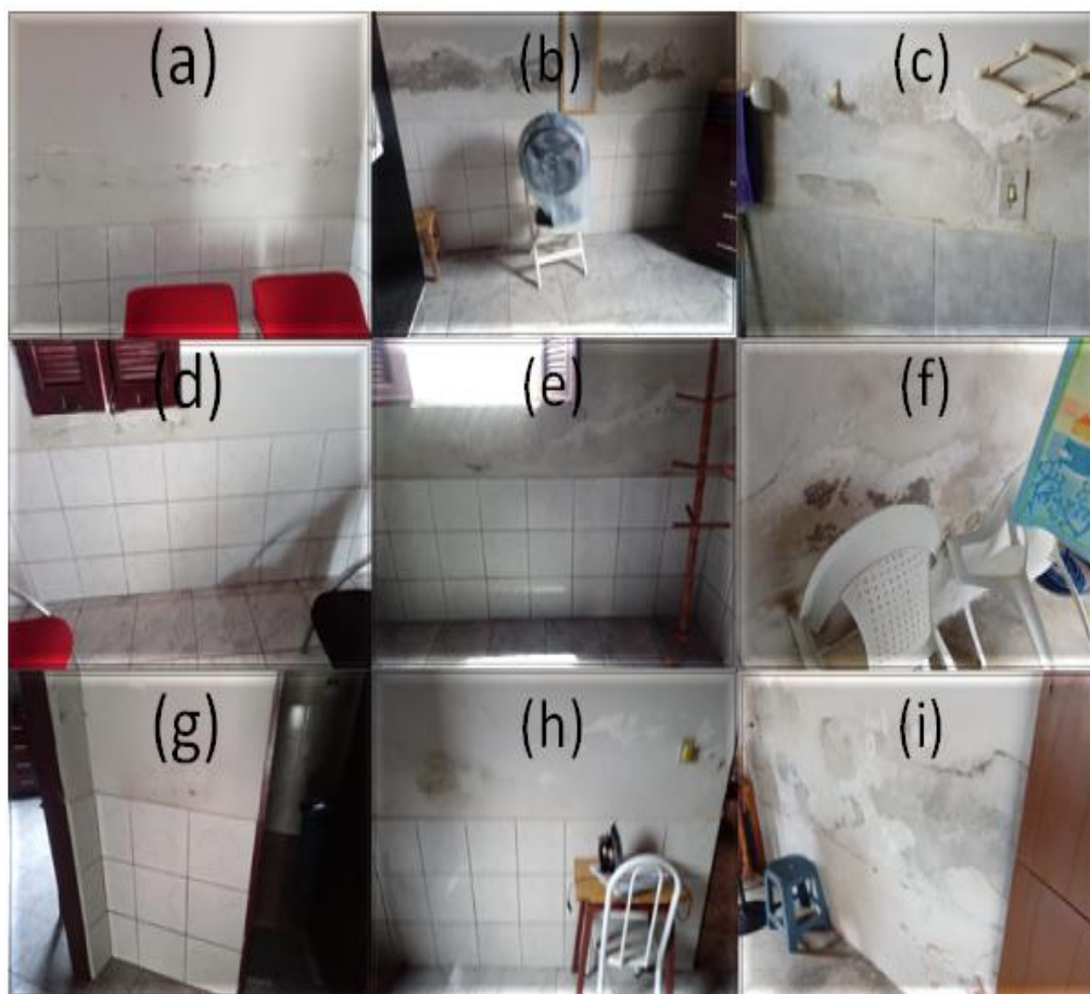
Figura 14: Infiltrações e eflorescências no terceiro edifício.
