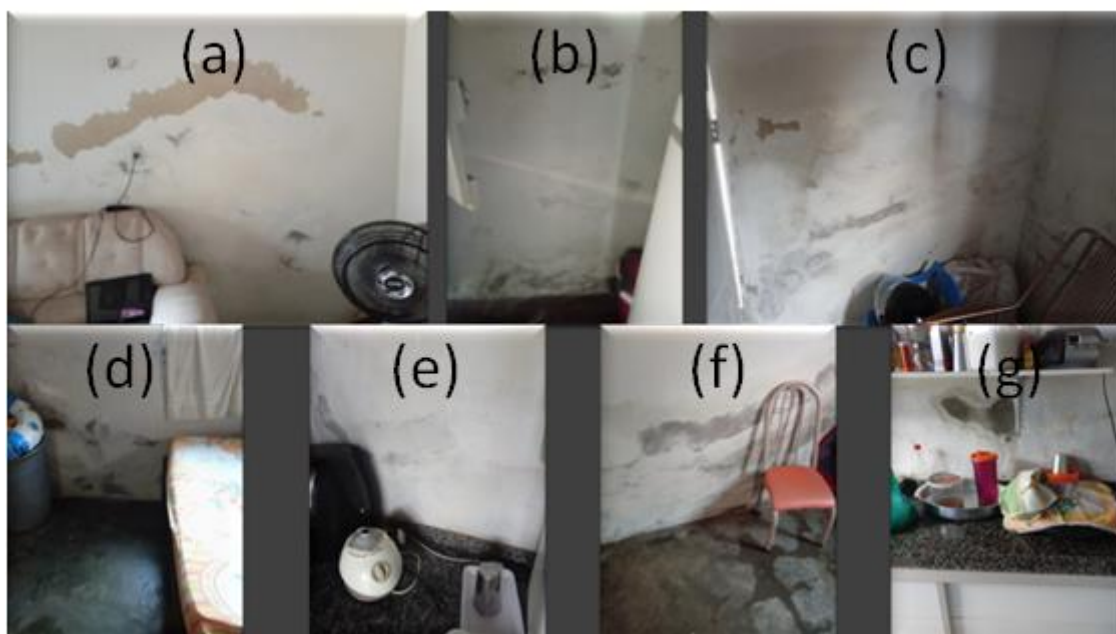
Figura 10: Infiltrações e eflorescências no primeiro edifício.
