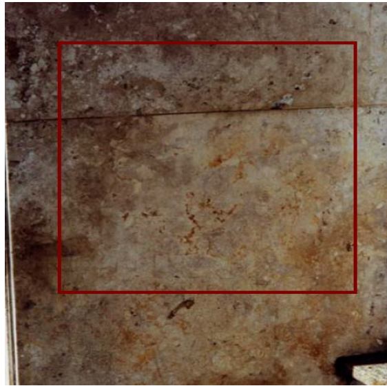
Figura 7 – Descamação em pedra de granito
