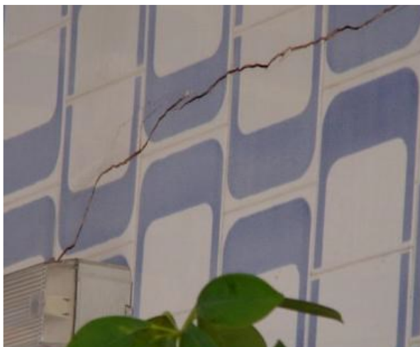
Figura 5 – Fissuras em revestimento
