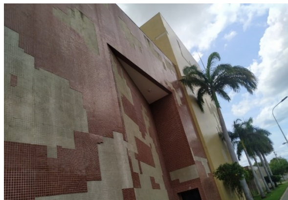
Figura 45 - Desplacamento de revestimentos do Teatro Dix-Hiut Rosado.
