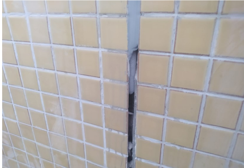
Figura 35 - Junta de dilatação com Tarucel e selante.
