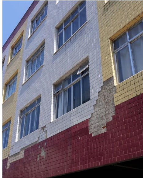
Figura 4 - Desplacamento de revestimento cerâmico
