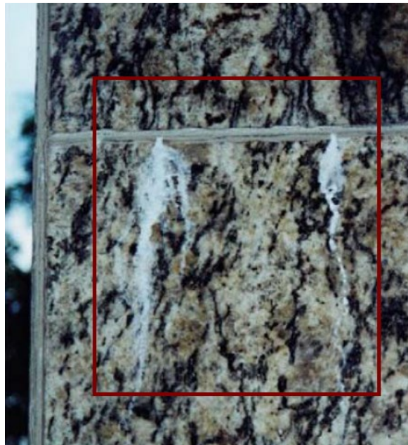
Figura 6 – Eflorescência em pedra de granito
