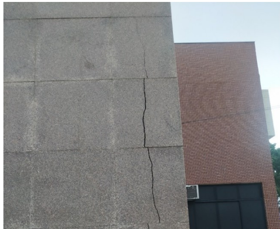
Figura 44 - Trincas do Teatro Dix-Huit Rosado.
