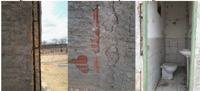
Figura 7 - Danos a estrutura do atual prédio da Agrosmel
