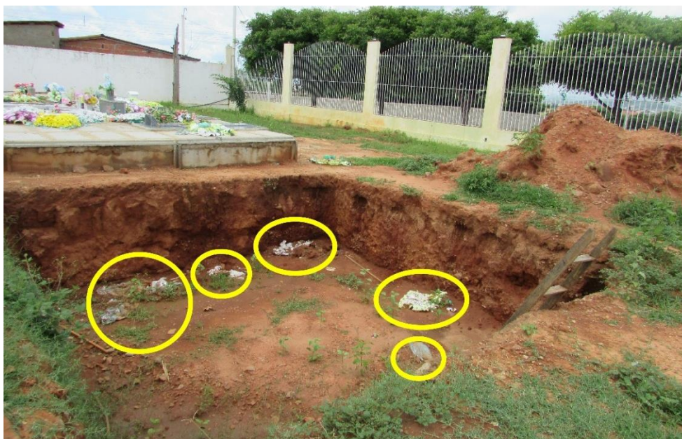
Figura 30: Identificação de resíduos na vala aberta.
