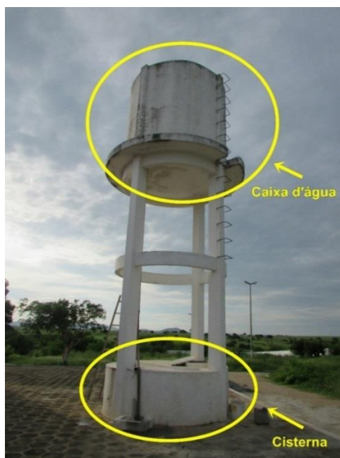
Figura 23: Localização da caixa d'água e cisterna do cemitério Parque da Saudade.
