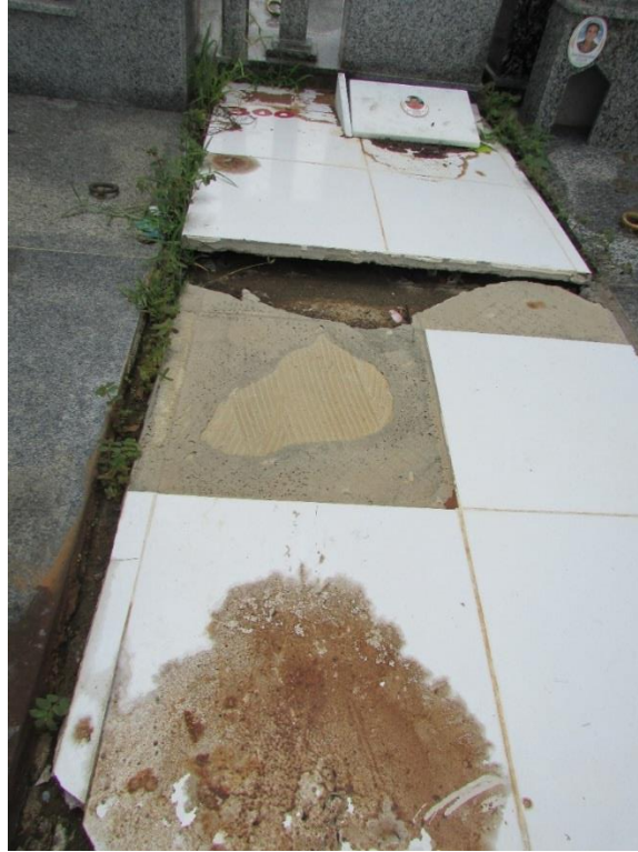
Figuras 58: Identificação de fissuras e abertura em um jazigo no cemitério Parque da Saudade.
