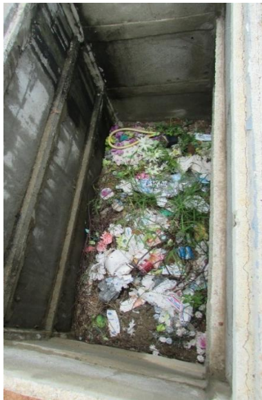
Figuras 49: Acúmulo de resíduo no interior do jazigo 02.
