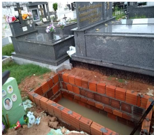
Figura 55: Acúmulo de água em um jazigo no cemitério São Manoel.
