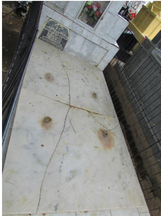
Figuras 59: Identificação de fissuras em um jazigo no cemitério São Manoel.
