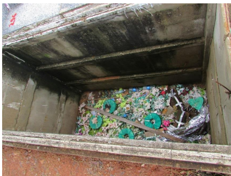
Figuras 57: Acúmulo de resíduos em um jazigo.
