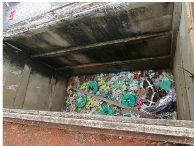
Figura 48: Acúmulo de resíduo no interior do jazigo 01.
