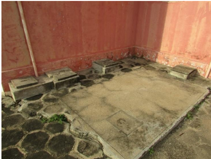
Figura 17: Local da fossa séptica no cemitério Parque da Saudade.
