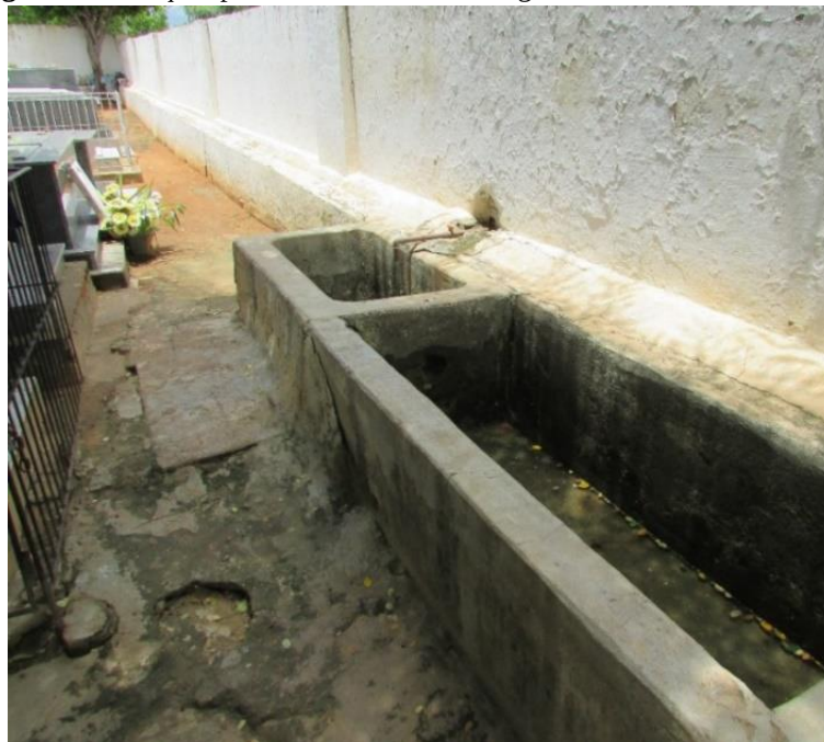
Figura 24: Tanques para armazenamento de água no cemitério São Manoel.
