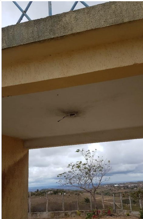
Figura 12: Luminária do mirante danificada
