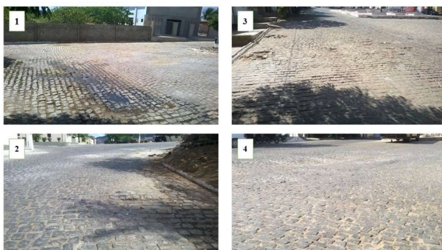
Figura 15 : Pavimento danificado em diversos pontos da cidade
